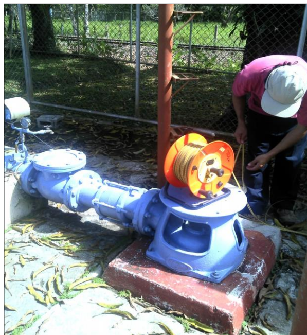
Fotografía 9. Pozo RB-98 (P-AyA-3, Campo de Pozos)
