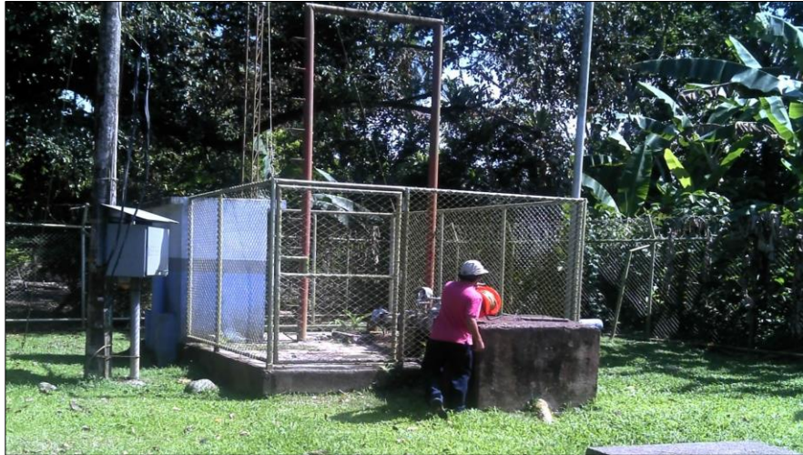
Fotografía 10. Pozo RB-59 (A y A-4, Campo de Pozos)
