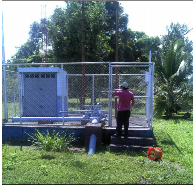
Fotografía 8. Pozo RB-100 (P-AyA-2, Campo de Pozos)
