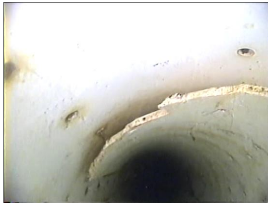
Fotografía 6: Tubo reventado aproximadamente a los 6 m
