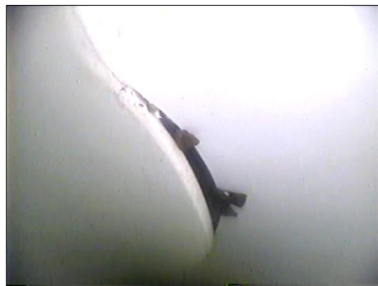
Fotografía 7: Tubo reventado aproximadamente a los 28 m
