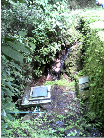
Fotografía 26. Tanque de almacenamiento Fuente #1 Barbacoas AyA. Coordenada E 497658 m, N 203861 m, Costa Rica Lambert Norte.
