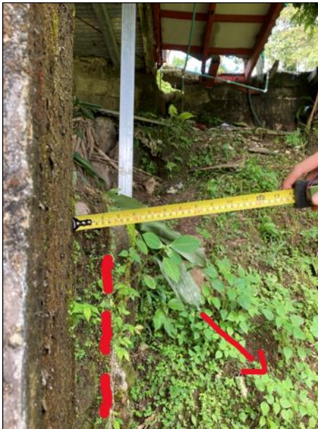
Foto 9. Desplazamiento de muro con respecto a columna. (Coordenadas 975228 N / 612915 E).
