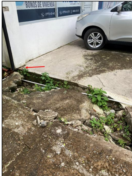
Foto 13. Punto en el cual se encontraban unidades las estructuras por medio de acero que posteriormente fueron separadas por el propietario para evitar mayores daños al edificio comercial.
