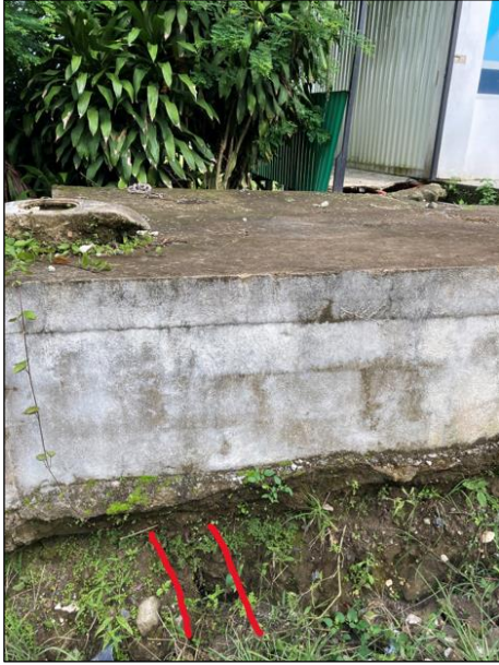
Foto 11. Ruptura en material bajo losa de concreto. (Coordenadas 975228 N / 612921 E).
