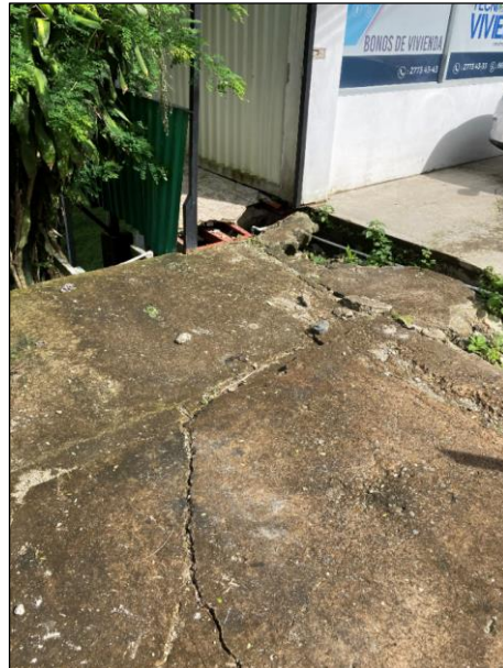
Foto 10. Ruptura superficial en losa de concreto. (Coordenadas 975232 N / 612920 E).
