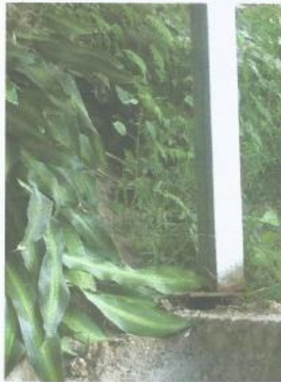
Fotografía 4. Desplazamiento y falla de cimientos.
