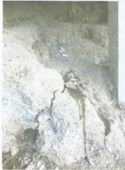
Fotografía 3. Grietas en la zona de fundación del local comercial.
