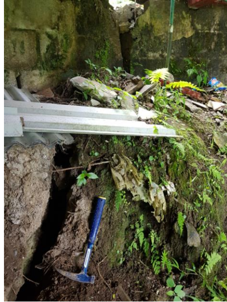
Foto 8. Ruptura en sección inferior de losa de concreto. (Coordenadas 975229 N / 612917 E).
