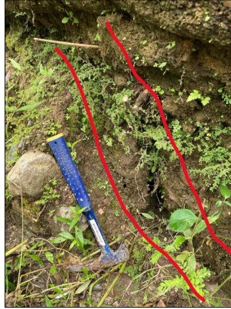
Foto 12. Detalle de ruptura de material bajo la losa de concreto. (Coordenadas 975228 N / 612921 E).
