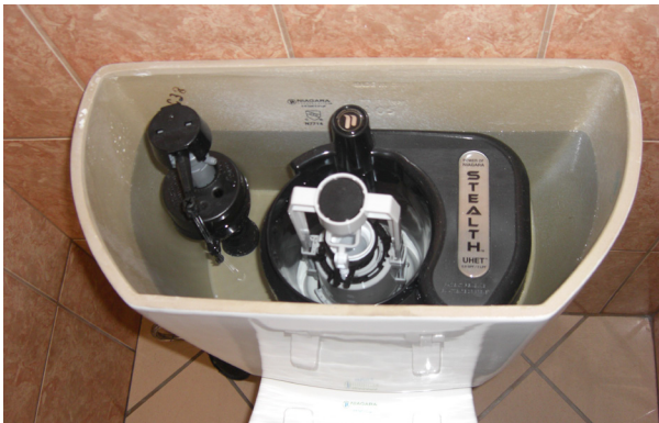
Fotografía No 1: Tanque del servicio sanitario de bajo consumo de 3 litros por descarga
