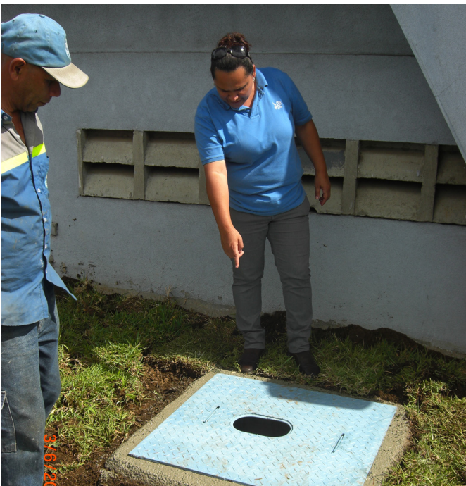
Fotografía No 5: Caja de protección del medidor principal instalado
