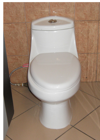
Fotografía No 2: Registro de consumo de servicio sanitario instalado
