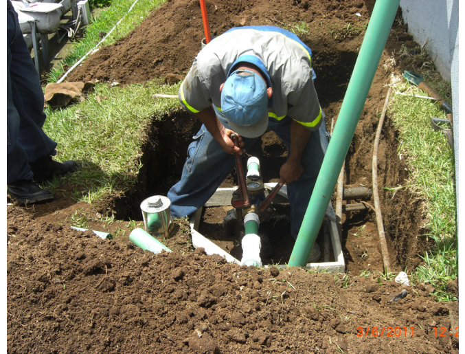
Fotografía No 4: Medidor principal instalado
