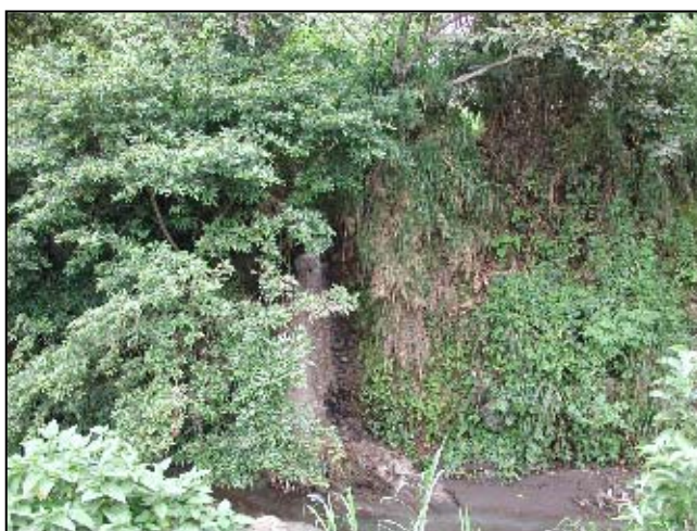
Foto 52. Efluentes de aguas negras y talud izquierdo del Río Tiribí en su paso por Dulce Nombre.
