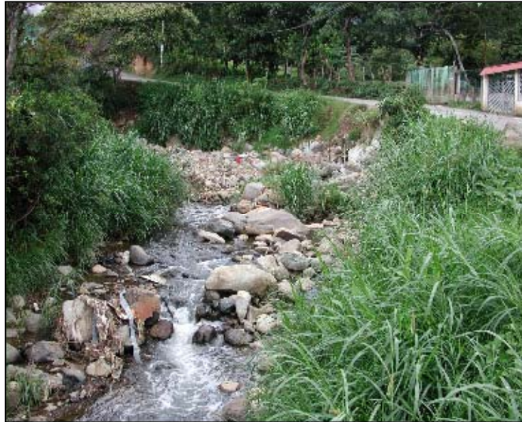
Foto 55. Erosión lateral del Río Cañas cerca de la confluencia con el Río Parrúas. En este sector el colector se ubica sobre la margen que está siendo erosionada.
