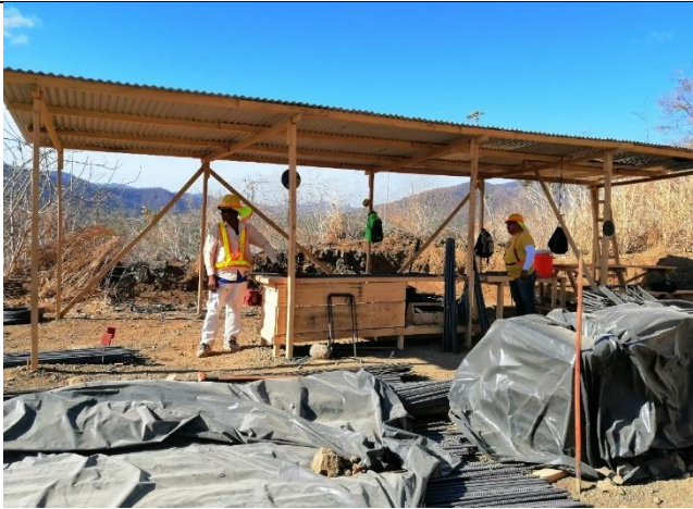
Figura 18. Trabajadores con el EPP incompleto.
