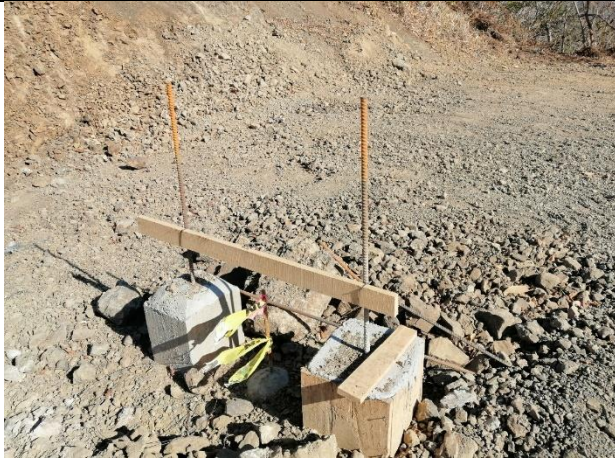
Figura 20. Varillas sin protección en las puntas.
