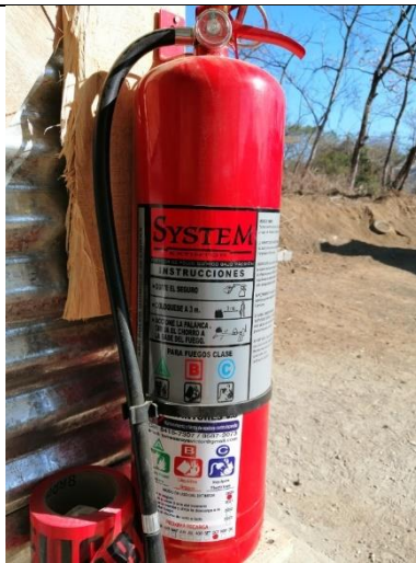
Figura 24. Extintor en la zona de bodega.
