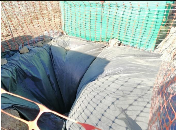
Figura 21. Fosa de lavado de concreto.
