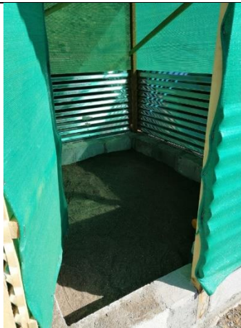
Figura 27. Acondicionamiento de bodega para combustibles.
