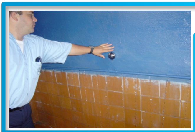
Fotografía No. 7: Orinal tipo “cascada” operado con válvula temporizada instalada con la mejora. Automotización en el abastecimiento de agua en la pila del comedor estudiantil de la Escuela República de Haití, las figuras No 8 y 9 muestran detalles
