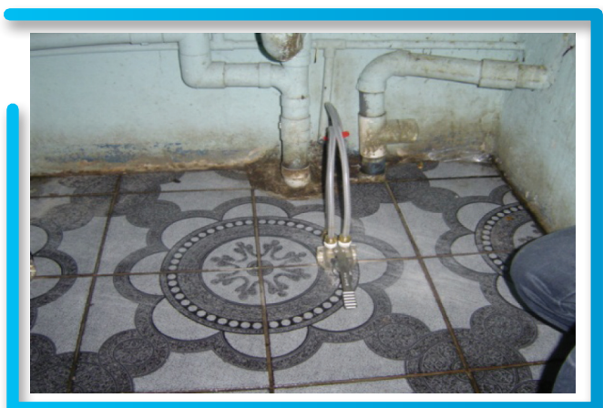
Fotografía No. 8: Válvula temporizada automática bajo el fregadero
