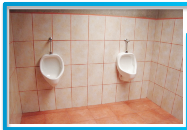
Fotografía No. 13: Orinal con válvula temporizada, Escuela Betania. Una nueva construcción
