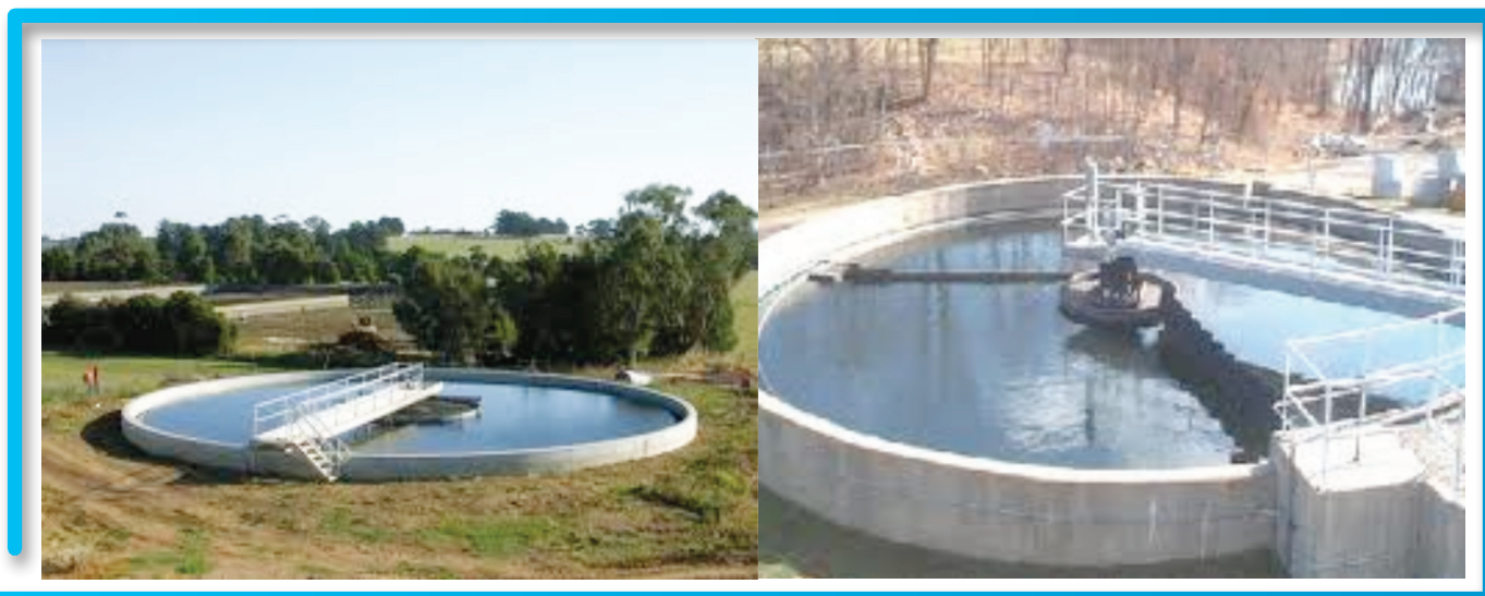
Fotografía No. 1: Sedimentadores circulares
