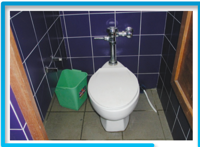
Fotografía No. 16: Servicio sanitario con válvula temporizada tipo fluxómetro en Escuela Omar Dengo
