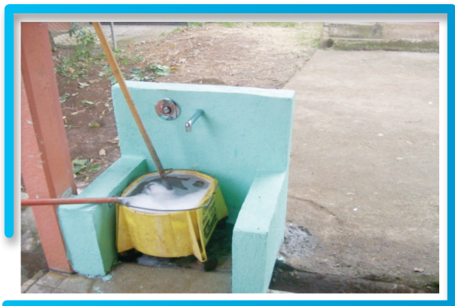
Fotografía No. 15: Pileta para limpieza de trapo piso, con válvula automática, en Escuela Maiquetía
