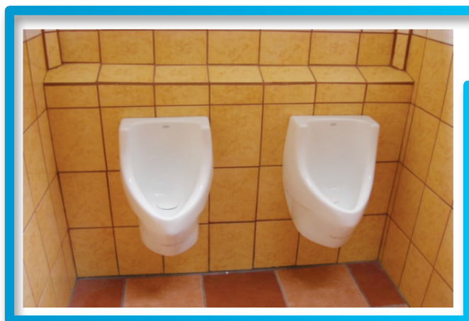
Fotografía No. 12: Orinal tipo mingitorio “water free”, Escuela Juan E. Pestalozzi Antes orinal tipo “cascada”
