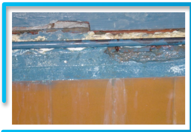
Fotografía No. 6: Orinal tipo "cascada" antes de la intervención en la Escuela República de Haití
