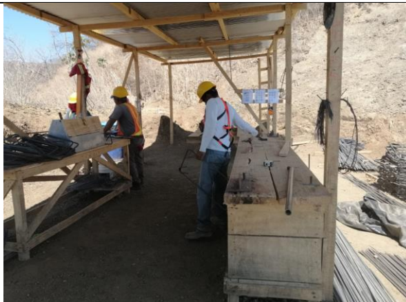
Figura 27. Trabajadores con el EPP incompleto.
