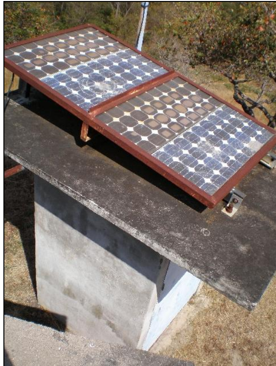
Figura 2.4. Tanque Sardinal: caseta de telemetría con alimentación solar.
