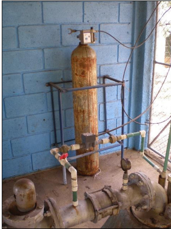
Figura 2.2. Sistema de cloración del Pozo #1.
