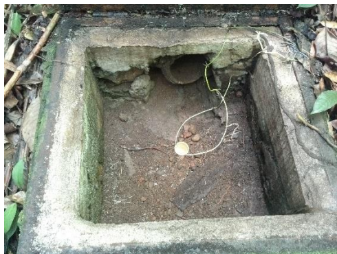
Fotografía 1: Interior de la captación de la naciente Maroto 3, se evidencia la ausencia de caudal en esta naciente al momento de la visita coordenadas (258404 N/ 484703 E)
