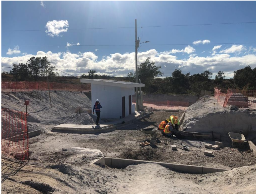
Foto 3 Acueducto de Liberia, zona del tanque Liberia
