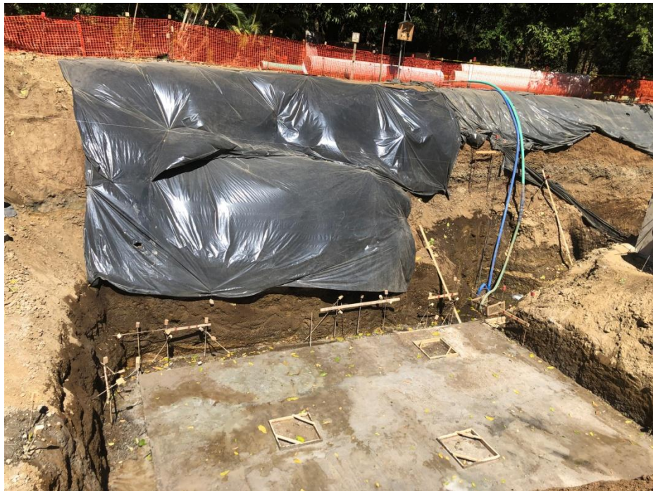
Foto 4 zona de cárcamos para bombas, Desarenador, Nicoya.
