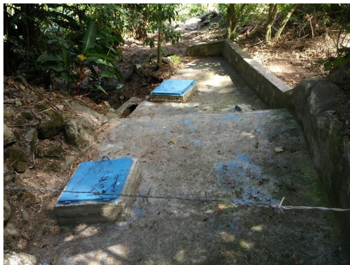
Fotografía 1: Captación de las nacientes Chiverrales. Coordenadas 190,030 N y 526,799 E (proyección Lambert Costa Rica Norte).
