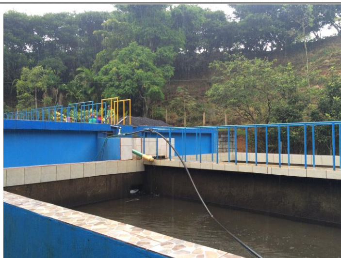
Fotografía 7: Planta de tratamiento coordenadas 570 216 – 134 511 Lambert.
