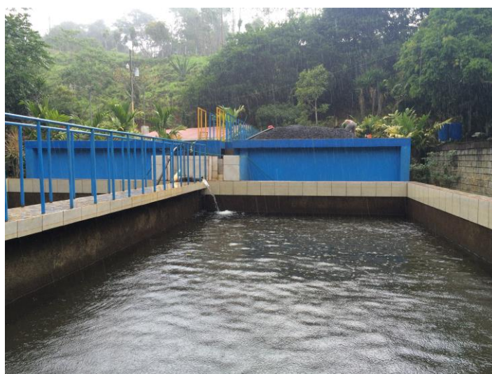
Fotografía 8: Planta de tratamiento aguas coordenadas 570 216 – 134 511 Lambert.
