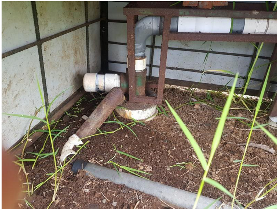
Fotografía N° 8 Vista de captación pozo Gary IS-537
