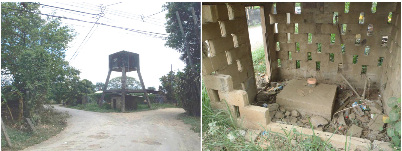
Fotografía 1. Estado actual del Pozo María Auxiliadora, 362318 E – 281573 N. Comunidad.
