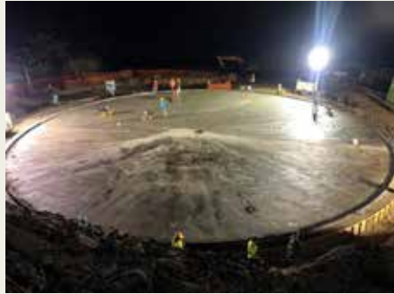
Nuevo tanque de Nicoya
