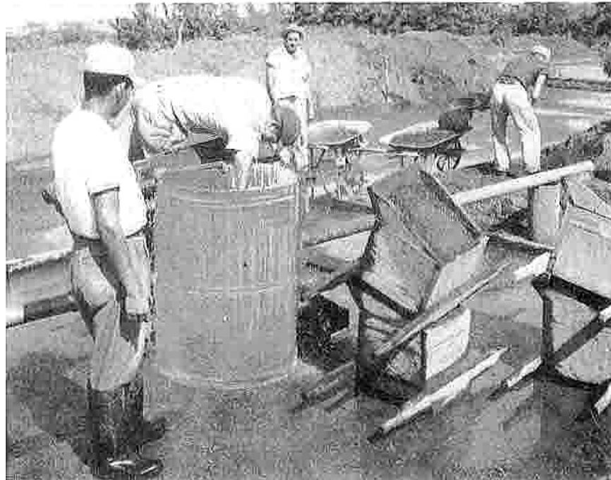
Cambio arena, filtros de Guadalupe
