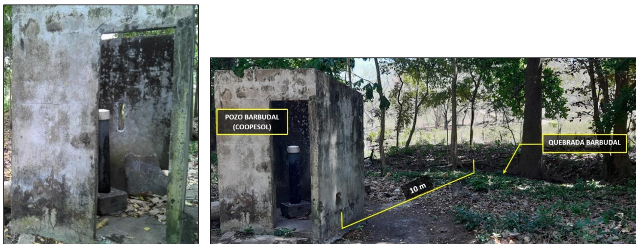
Fotografía 1. Ubicación del pozo Barbudal (propiedad de Coopesol) localizado en el sector de Colorado de Abangares, Guanacaste. (Coordenadas: 243132 N y 415423 E)
