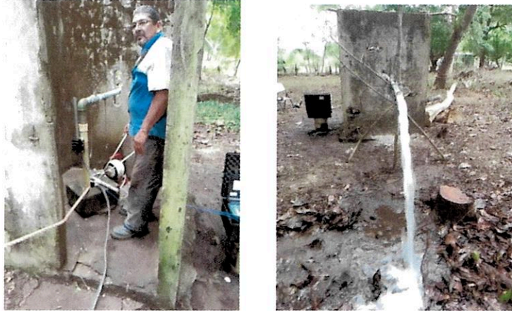
Fotografías 11-12: A la izquierda se muestra la instalación del equipo de bombeo sumergible, a la derecha el caudal de extracción empelado durante la prueba de bombeo a caudal constante (7,4 L/s).
