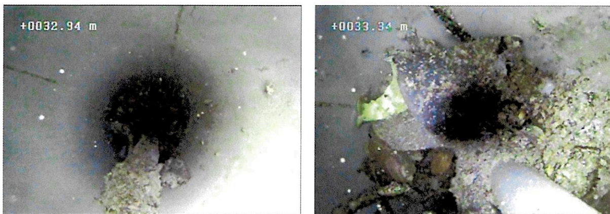
Fotografías 9-10: Ambas fotografías evidencian la acumulación de materiales en el interior del pozo, materiales que no permiten continuar con el descenso del equipo de filmación.
