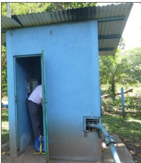
Fotografía 3. Pozo P-1: AyA Barbudal, localizado en la comunidad de Barbudal, a 200 m del pozo en estudio y que permanece en constante funcionamiento (Coordenadas: 243 116 N y 415 231E)
