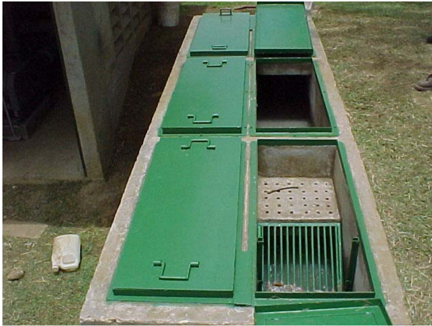
Cámara de rejillas y desarenador de pequeñas dimensiones.
