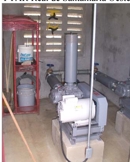
Interior de la Caseta de Sopladores y de Recirculación de Lodos
