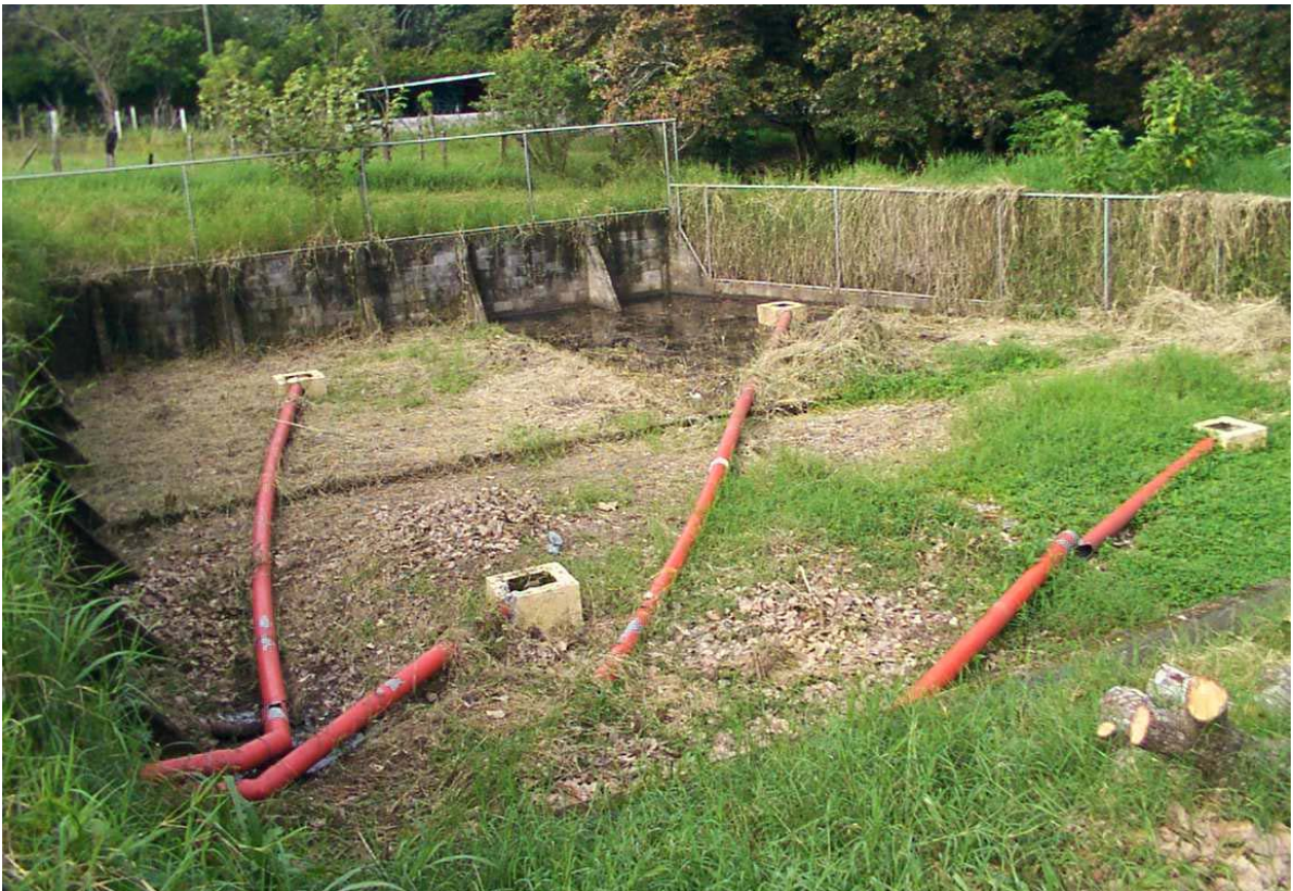
Filtro Anaerobio de Flujo Descendente obstruido y estructuras dañadas
