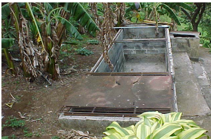
Cámara de rejillas
