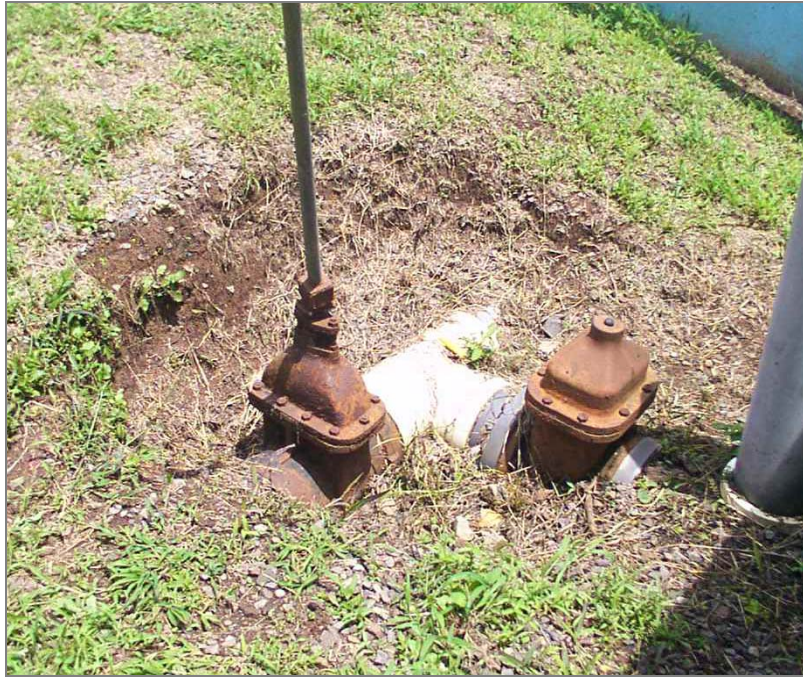
La válvula de la izquierda se encuentra trabada y la de la derecha está quebrada
