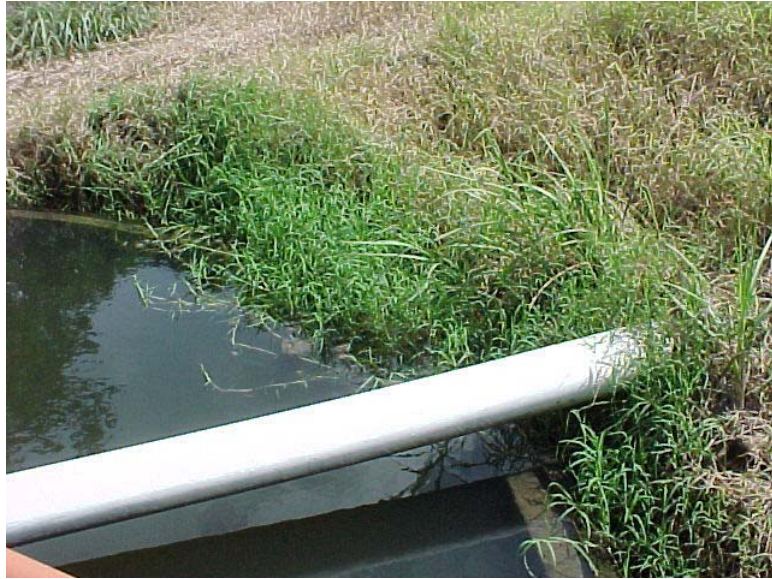
Maleza que ha crecido cerca del sedimentador secundario y ya está cubriendo parte del canal de recolección
