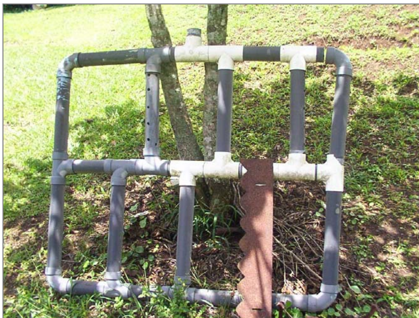
Estructura de distribución de caudales del FAFD y vertedero de entrada al UASB
