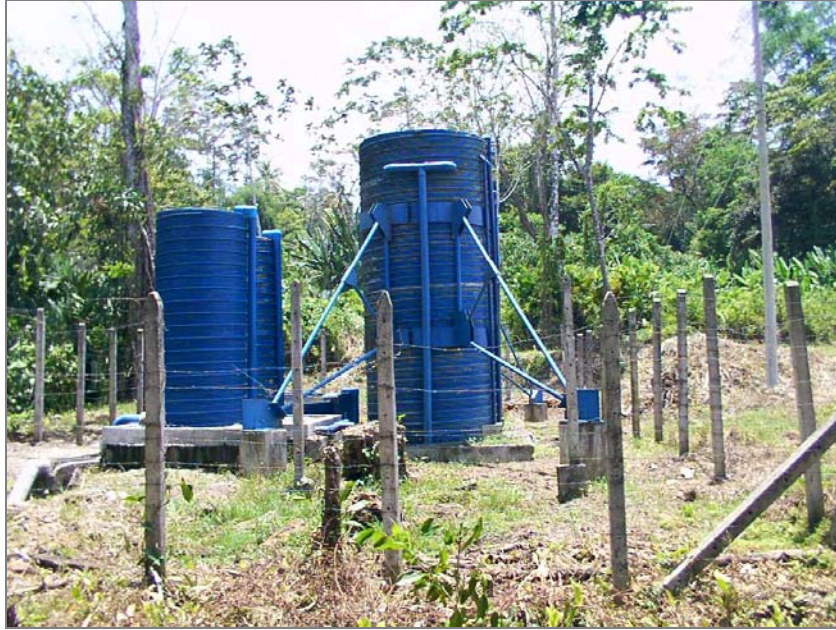
A la derecha se observan los filtros y a la izquierda los reactores anaeróbicos (son tres). Todas las estructuras son de plástico.
