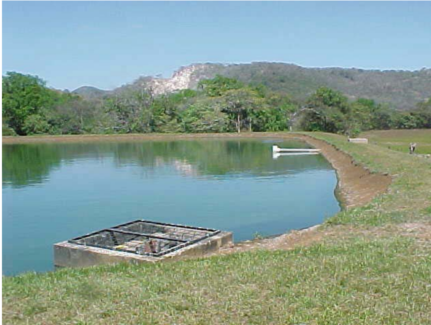
Al fondo se puede observar la tubería de salida de la laguna No. 2, así como la estructura de limpieza.
