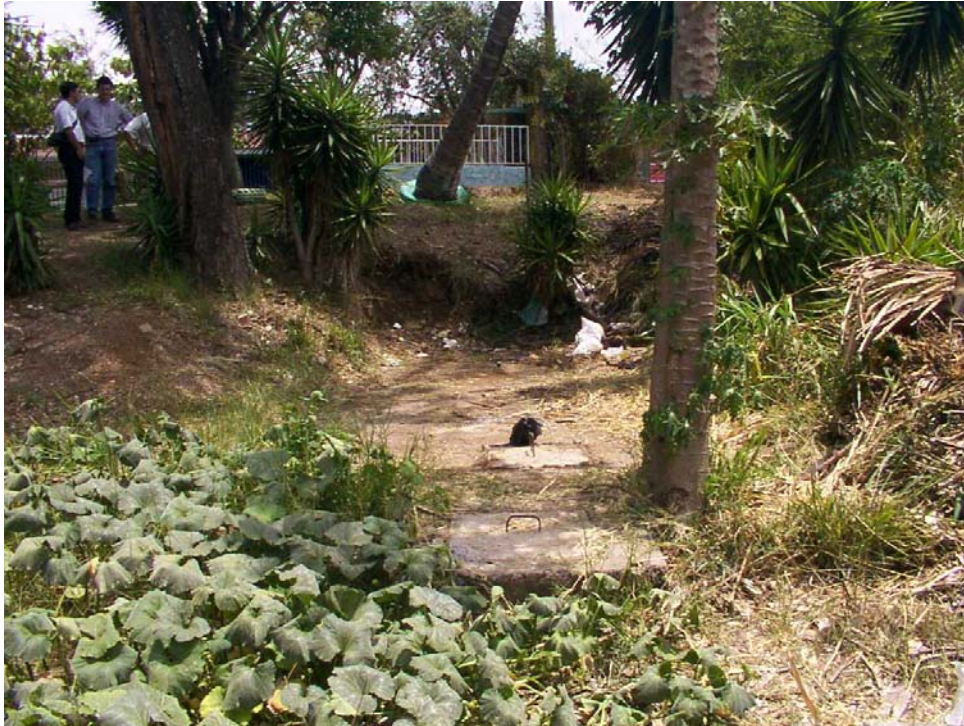
Tanque séptico que recibe las aguas residuales del INVU No. 1 y 2
