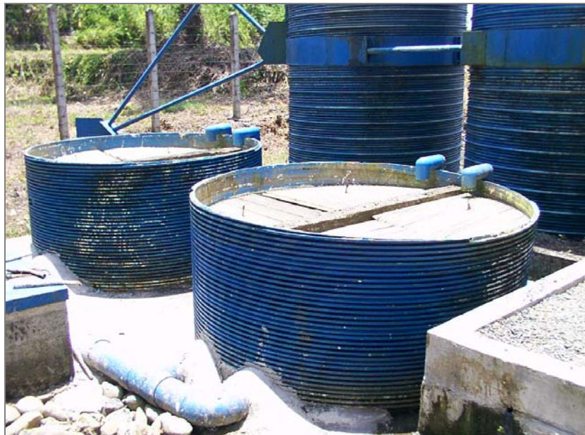
En primer plano se observan los lechos de secado, y al fondo los reactores anaeróbicos.
