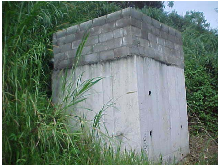
Filtro percolador torre
