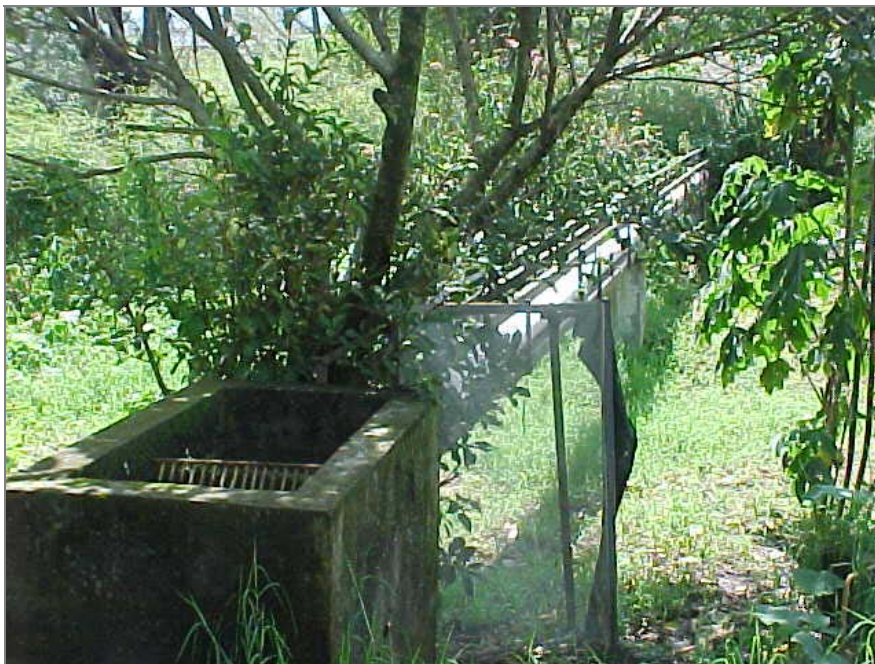
Cámara de Entrada y Rejillas y Línea de Conducción de las Aguas Residuales Crudas de la Urbanización Pinares
