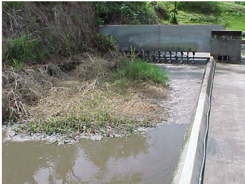
Se observa como la caída de tierra del talud norte ha provocado que el paso del lodo activado se haya estrangulado y este ocasionando una acumulación de nata importante que ya cubre una parte del canal. (1 er muestreo)
