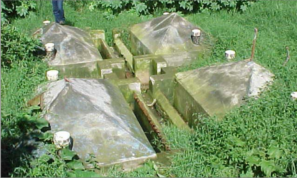
Vista General del UASB
