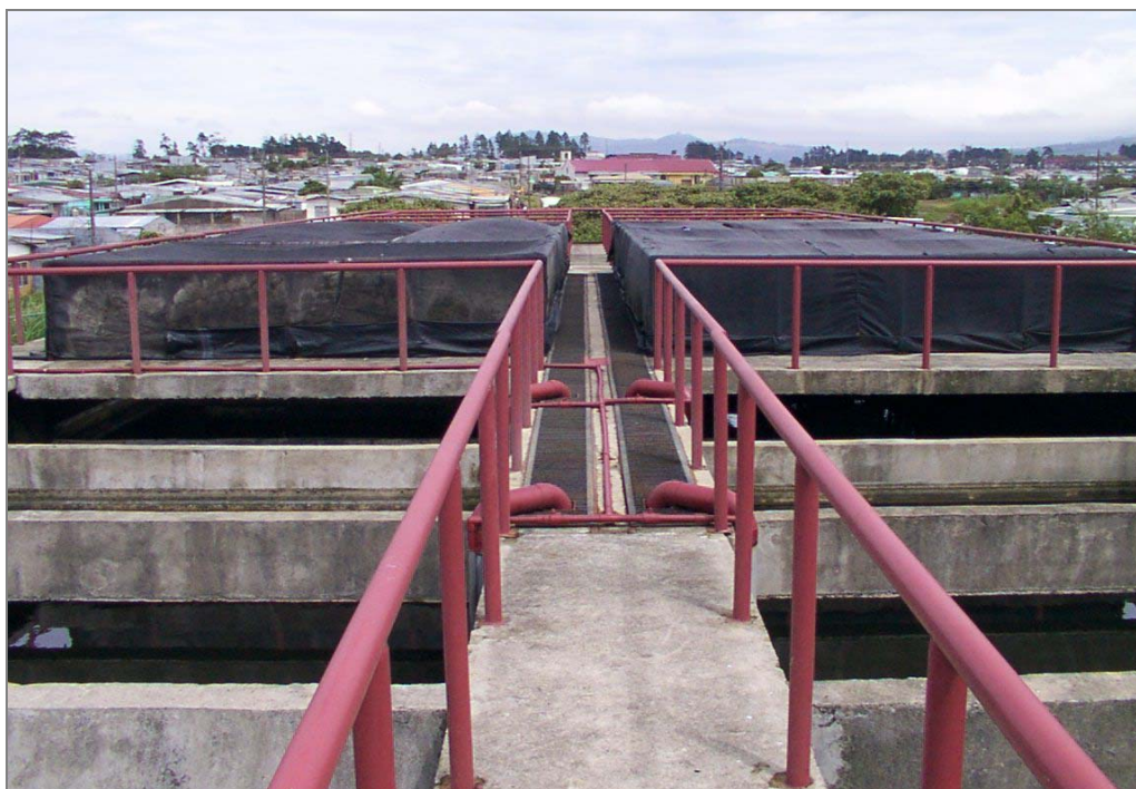
Sedimentador Primario, Tanque de Aireación (cubierto) y Sedimentador Secundario
