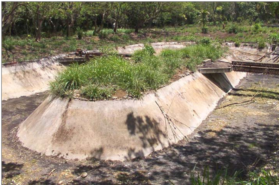
Canal de Oxidación
