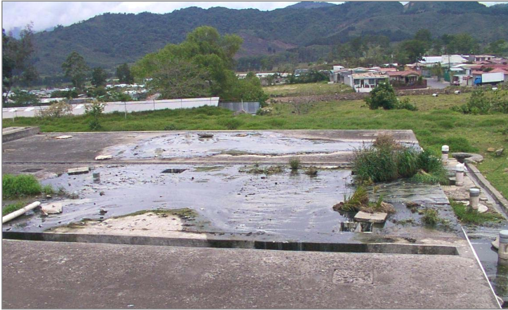
Problemas de obstrucción en dos compartimentos del FAFA
