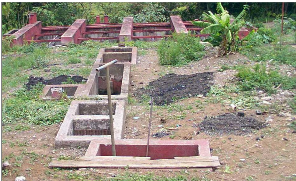
Fotografía 1. Estructuras en la entrada de la PTAR Silvia Eugenia.
