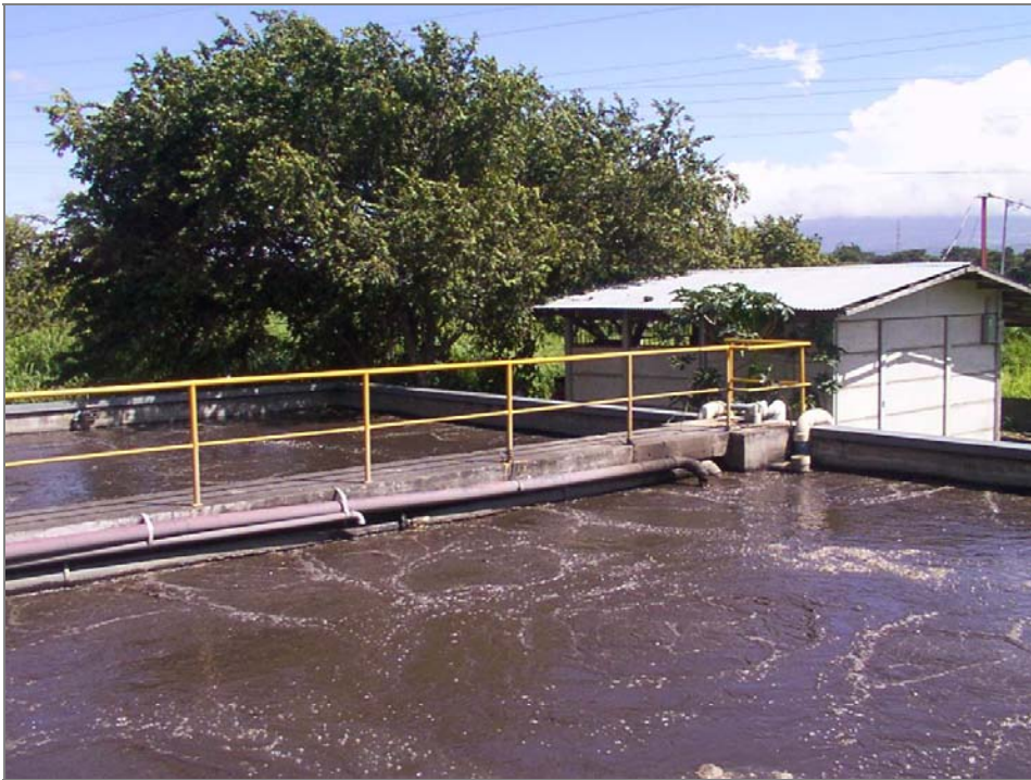
Tanque de Aireación y Caseta de Sopladores
