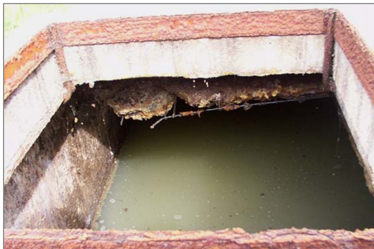
Estructuras Deterioradas en el Sedimentador
