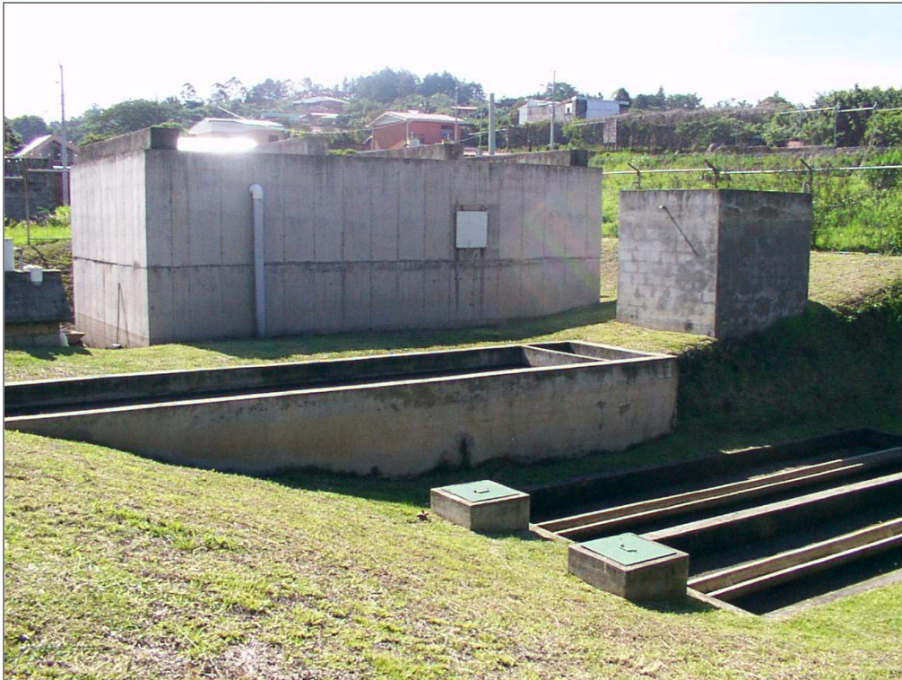
Vista general de las estructuras de la PTAR Bosques de Santa Ana
