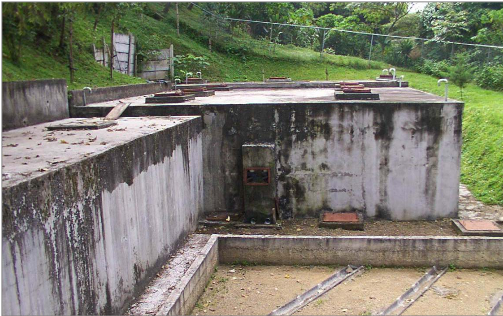
Fafa, Digestor de Lodos y Lecho de Secado
