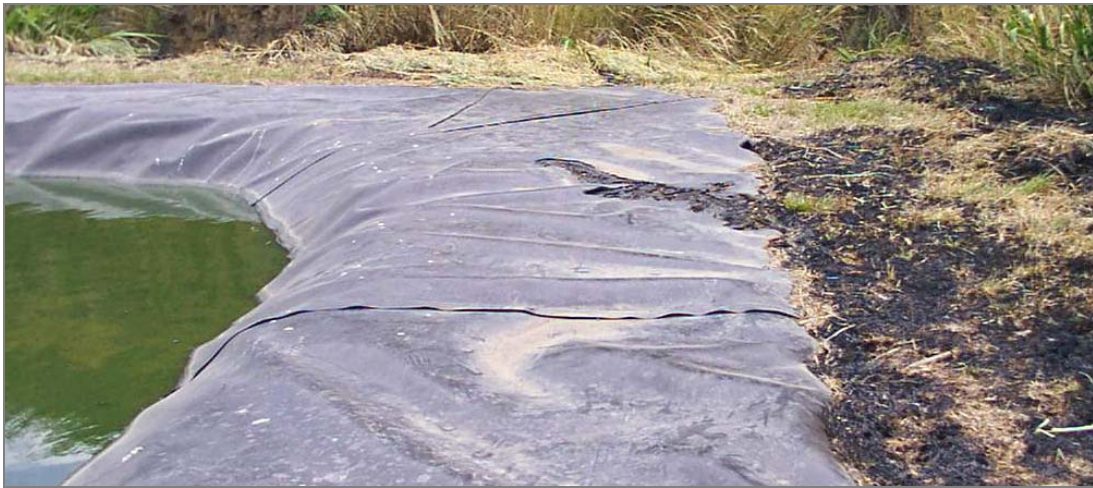
Geomembrana dañada por el fuego
