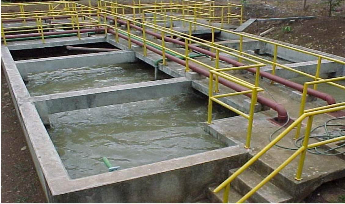
Planta de tratamiento tipo Lodos Activados Aireación Extendida (LAAE)
