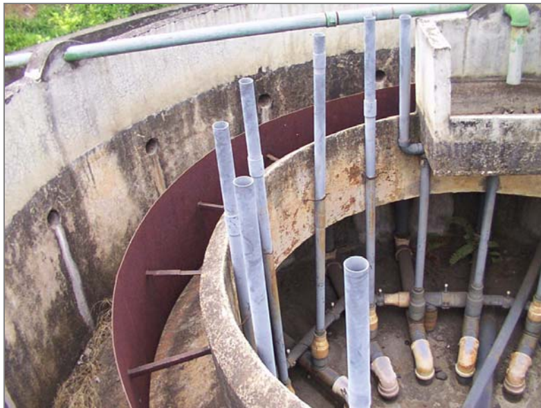
Interior del Tanque de Aireación y Sedimentador Secundario
