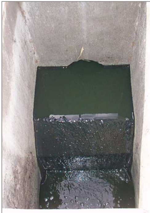
Estructura de salida central obstruida. La cantidad de agua que sale en comparación las otras dos, es mínima (1 er muestreo)
