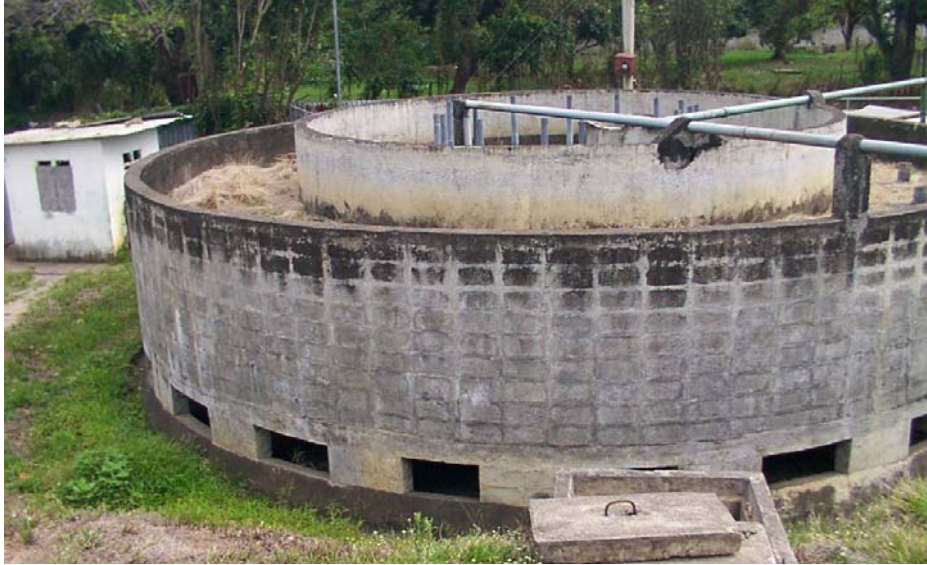
Tanque de Aireación, Sedimentador Secundario y Filtro de Piedra
