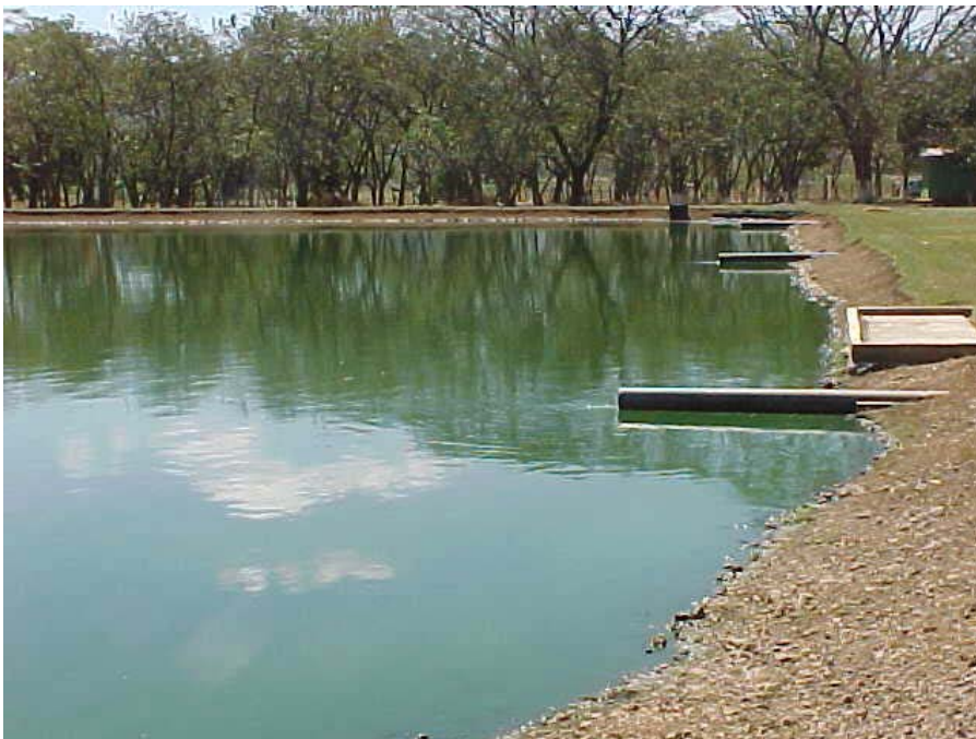
Se puede observar las tres tuberías de entrada de la laguna No. 1.
