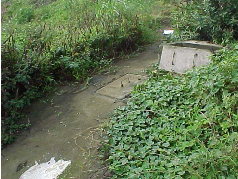
Sedimentador que recibe las aguas residuales de los tanques sépticos
