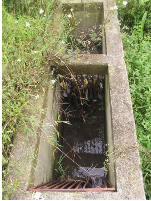
Debido a la obstrucción en las rejillas, el afluente no ingresa a la PTAR
