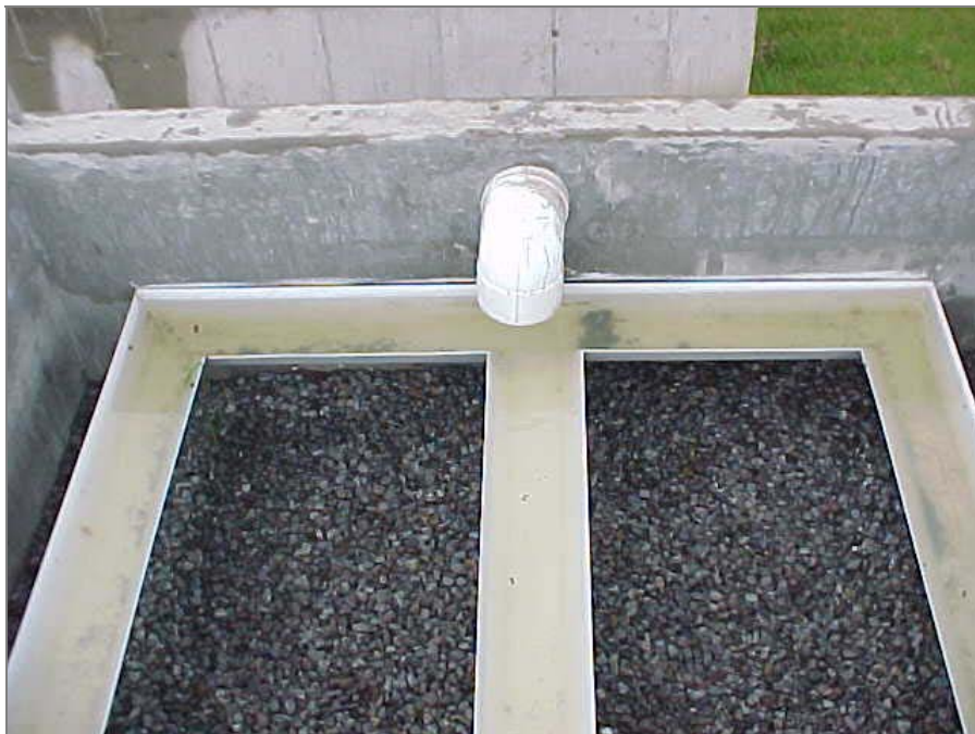
Filtro Anaerobio de Flujo Descendente (FAFD)
