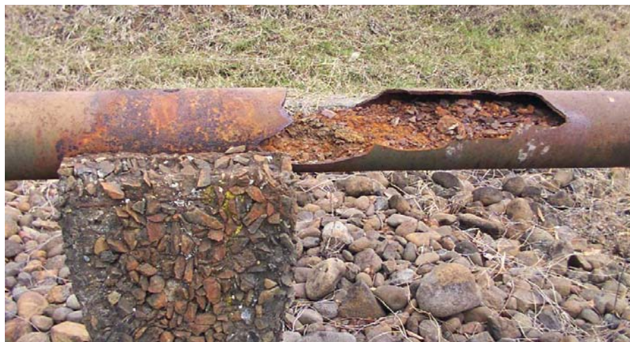
Tubería de hierro obstruida por sedimentos
