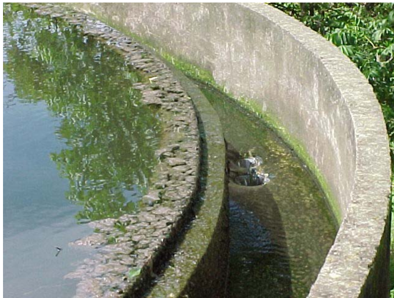
Se observa lodo sobrenadante cerca del vertedero circular en sedimentador Secundario. También se observa lana y lodo sedimentado en el canal de recolección, así como la salida del agua hacia el cuerpo receptor. (1 er muestreo)
