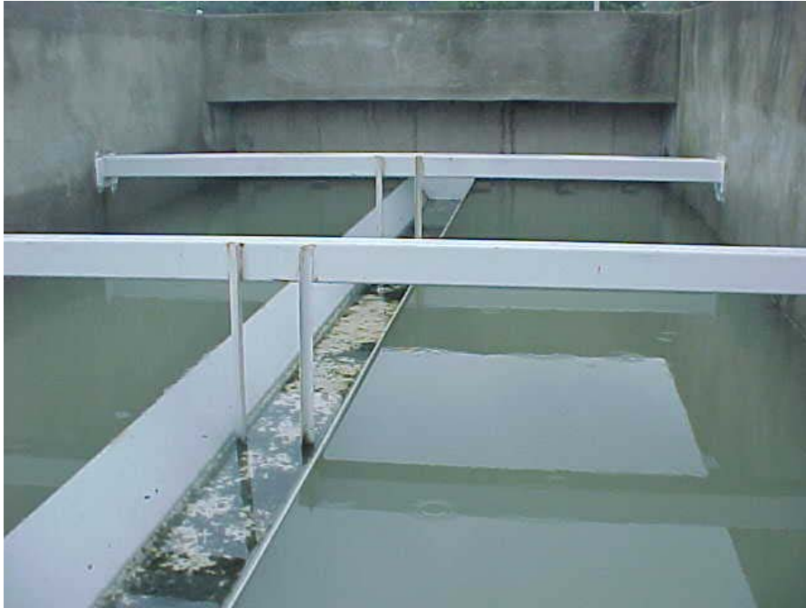
Interior del UASB
