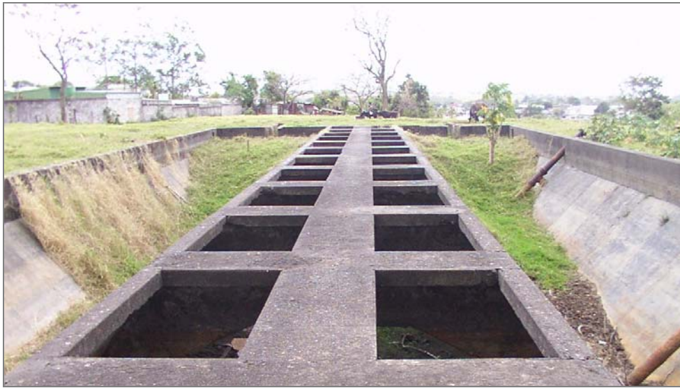
Tanque Imhoff (Sedimentador)
