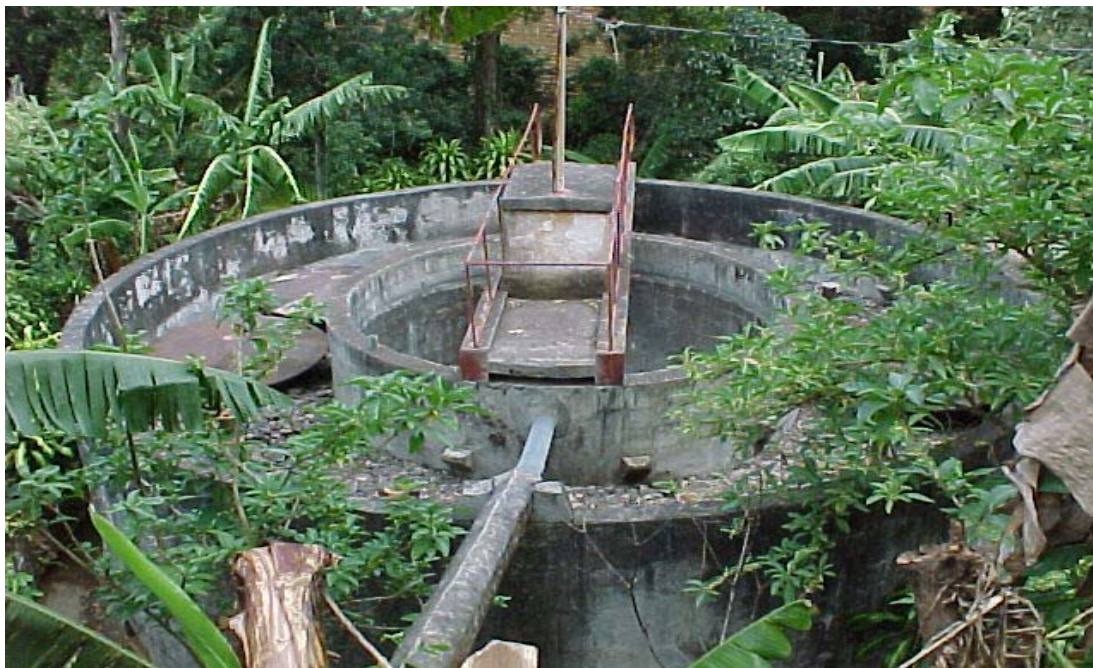
Tanque de aireación y filtro.
