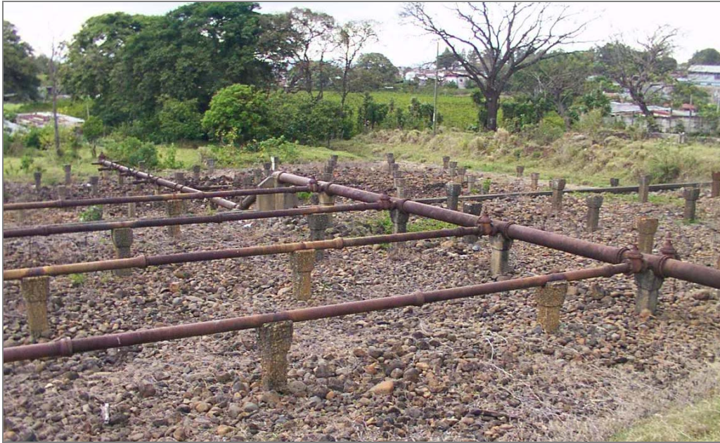
Filtros de Piedra
