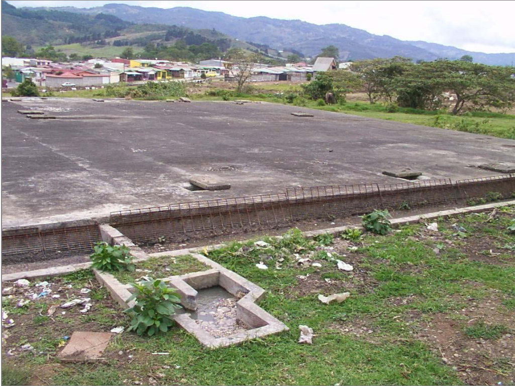
Cámara de rejillas, distribución de caudales, y Reactor Anaerobio de Flujo Horizontal
