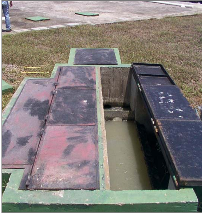
Estructura de Medición y Distribución de Caudales
