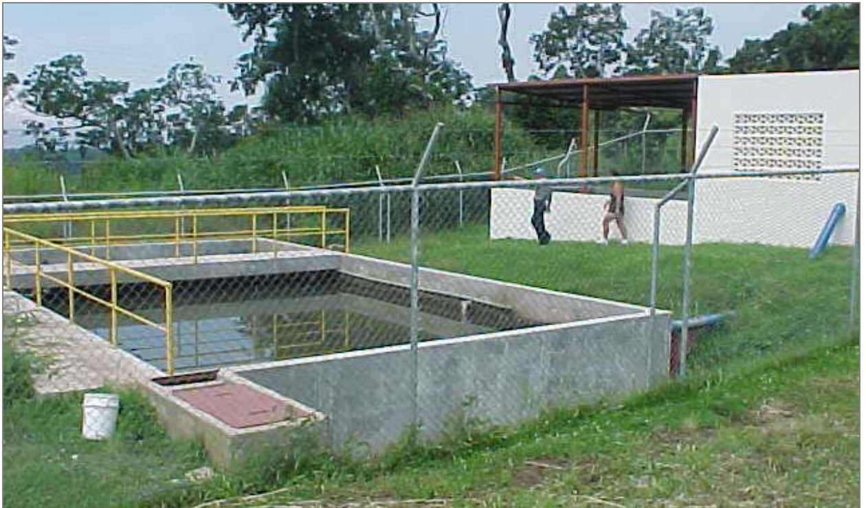
PTAR André Challé III Etapa
