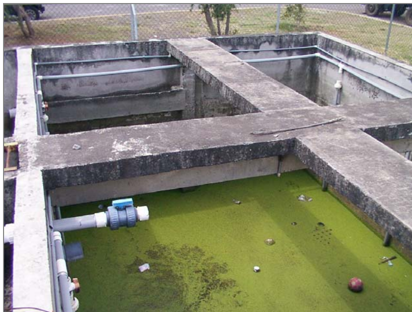
Tanque de Aireación
