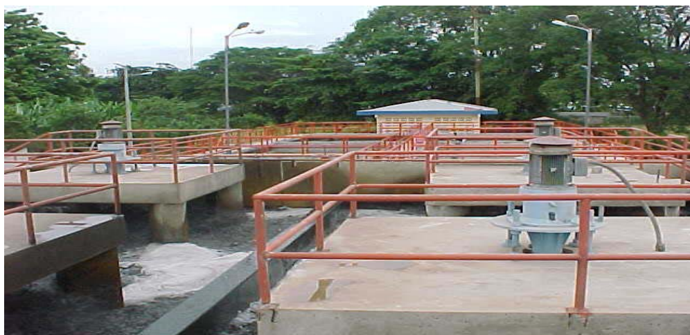
Tanques de aireación. La aireación se lleva a cabo mediante 6 mezcladores superficiales
