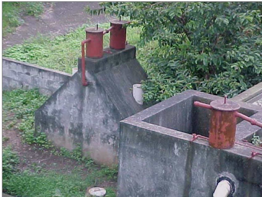
Biodigestor y Sistema de Recolección de Gases
