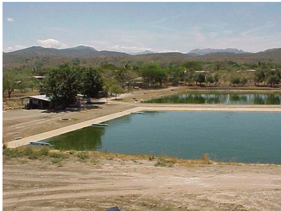
Se observan las lagunas primarias y las tuberías de entrada.
