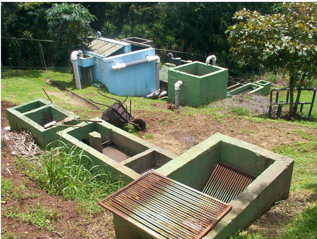
Vista General de las estructuras de la PTAR San Cecilia
