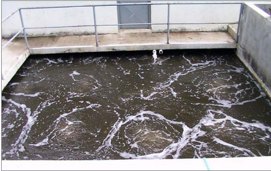
Tanque de Aireación
