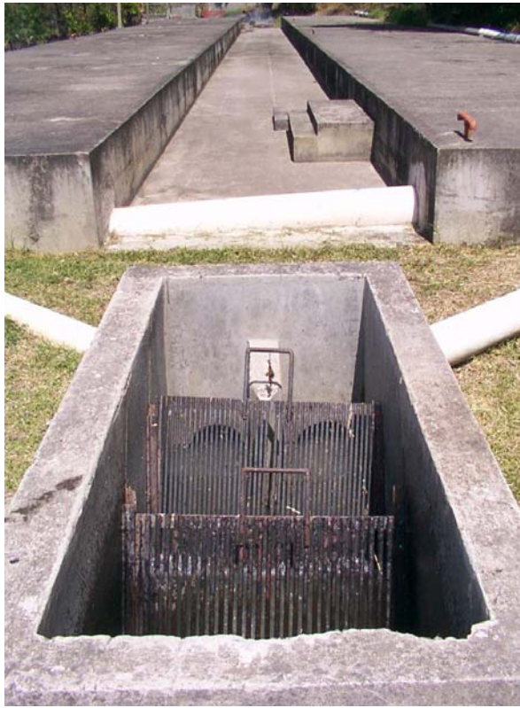
Cámara de rejillas y al fondo el sedimentador primario
