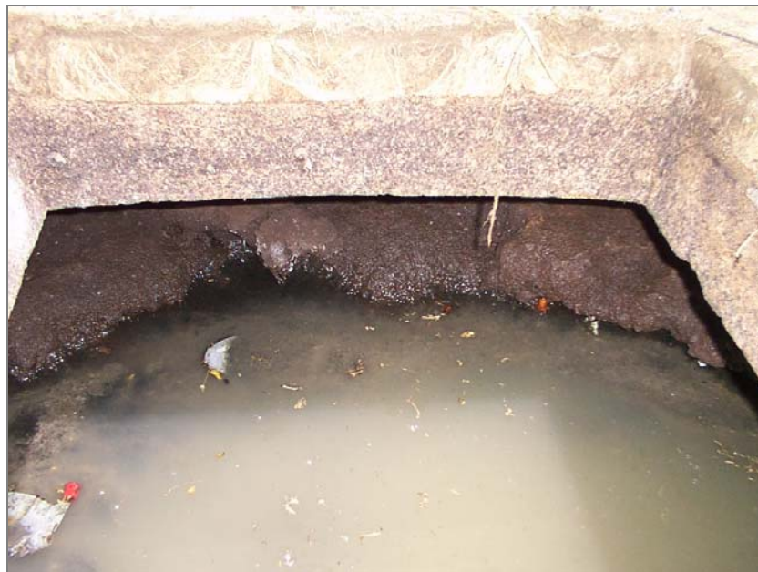
Se observa la gran cantidad de lodo que se a acumulado en el Tanque Séptico
