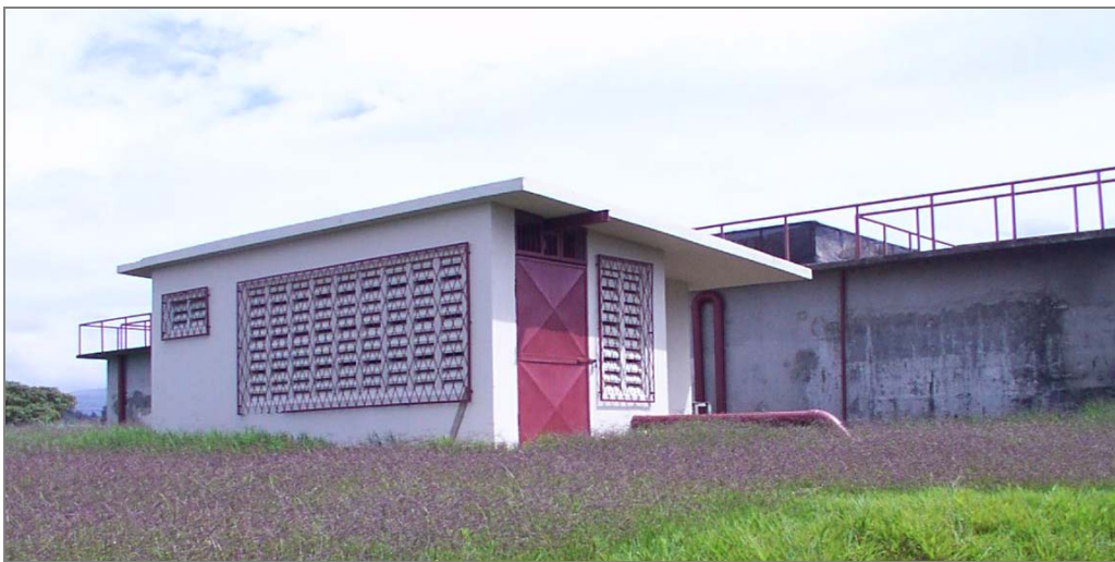
Caseta de compresores y de bombas de recirculación y purga de lodos
