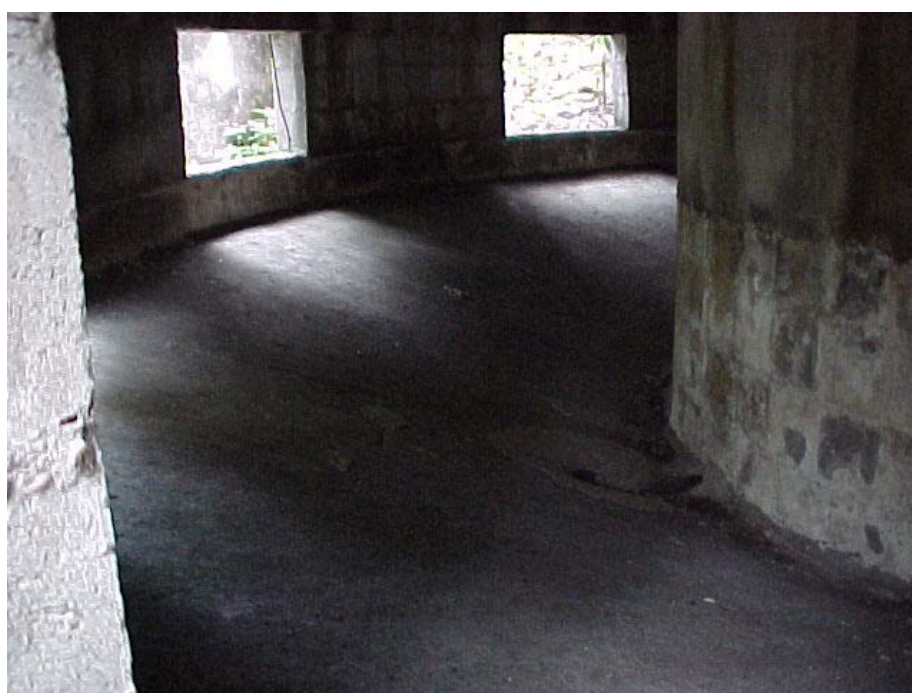
Sedimentador secundario que se localiza debajo del filtro de piedra.
