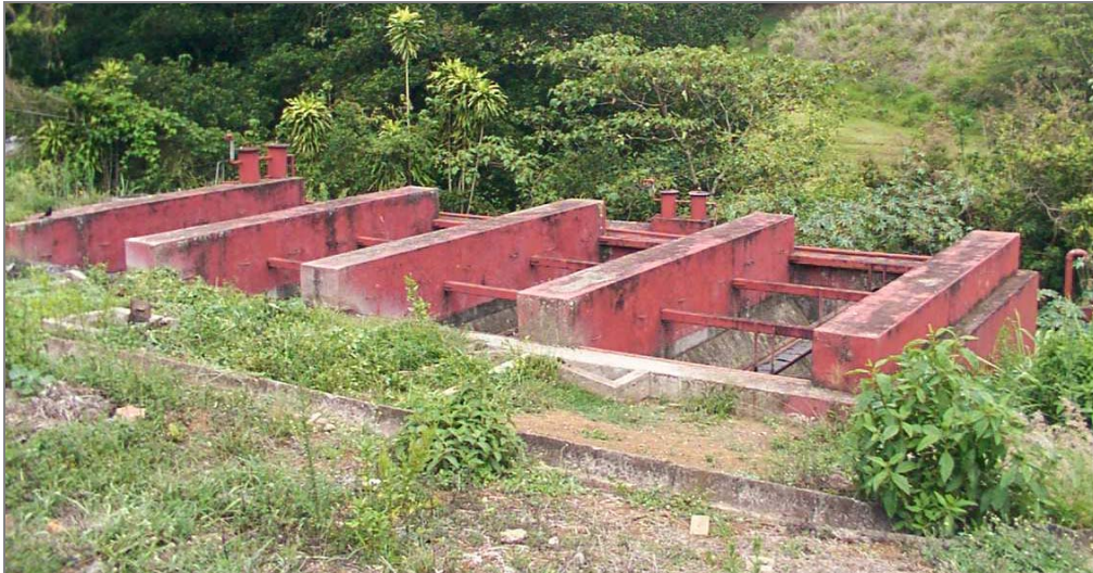
Fotografía 2. Reactor Anaerobio de Flujo Ascendente (UASB)
