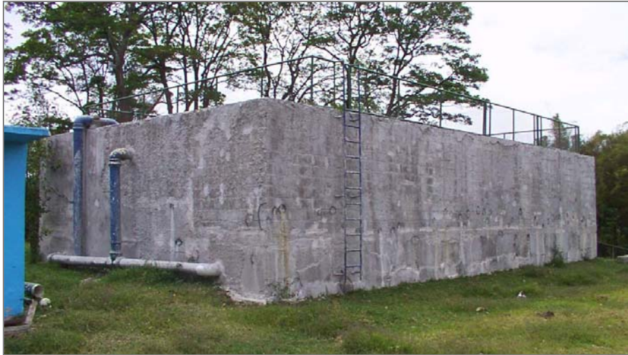
Filtro Anaerobio de Flujo Ascendente (FAFA)
