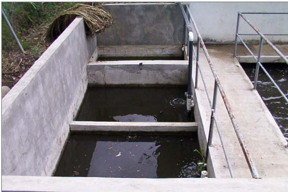
Sedimentador Secundario y Biodigestor
