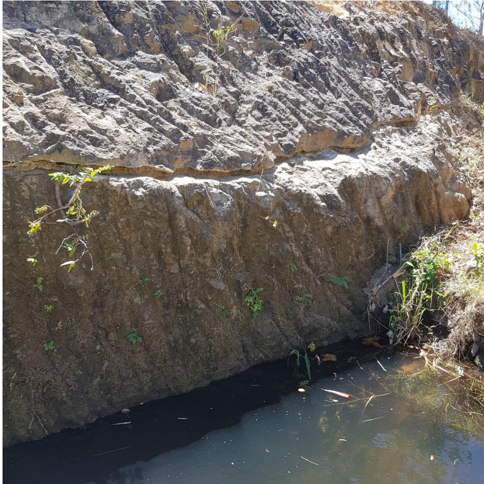
Figura 7. Fotografía del afloramiento de aguas en época de estiaje tomada durante la inspección.
