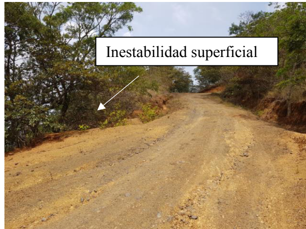
Fotografía N° 13. Inestabilidad superficial a orilla de camino.
