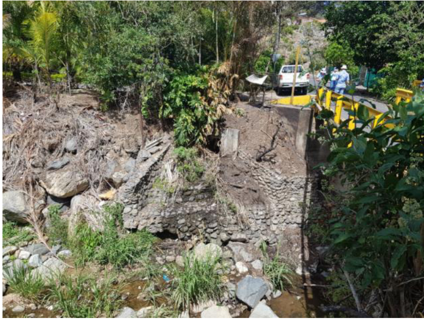
Fotografía N° 8 Vista de paso de Río Uruca desde margen derecha. Nótese la estructura de protección de los bastiones del puente y la socavación de la misma. Coordenadas Lambert Norte (211608/518009)
