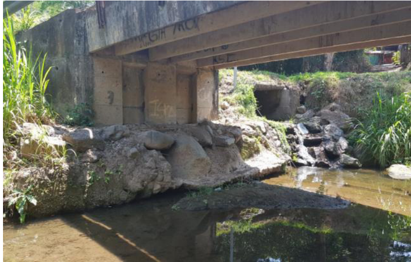
Fotografía N° 10. Vista de bastión de margen derecha de puente carretero sobre el Río Pacacua. Nótese el ciclópeo de protección medida que deberá de ser considerada para proteger los cimientos del nuevo puente.
