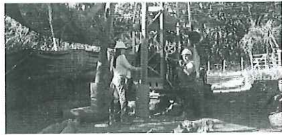
Labores de perforación del pozo 15-24 mediante el método de percusión máquina perforadora 60RLn°3.
