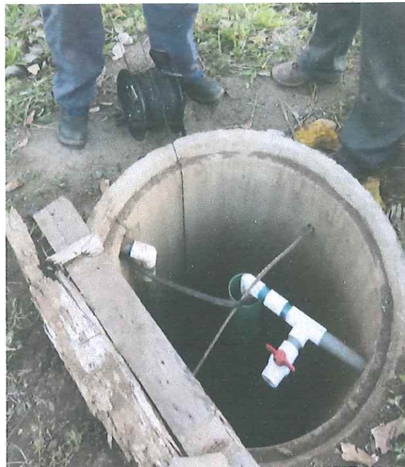
Fotografía 11. P-8, Pozo propiedad de Sr Paulino Porras (Coordenadas: 235 789 N y 443 656 E)
