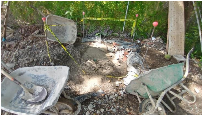
Pileta para restos de concreto.
