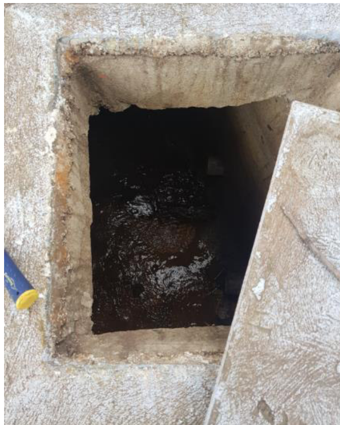
Fotografía N° 10 Captación Naciente Katadin 11.
