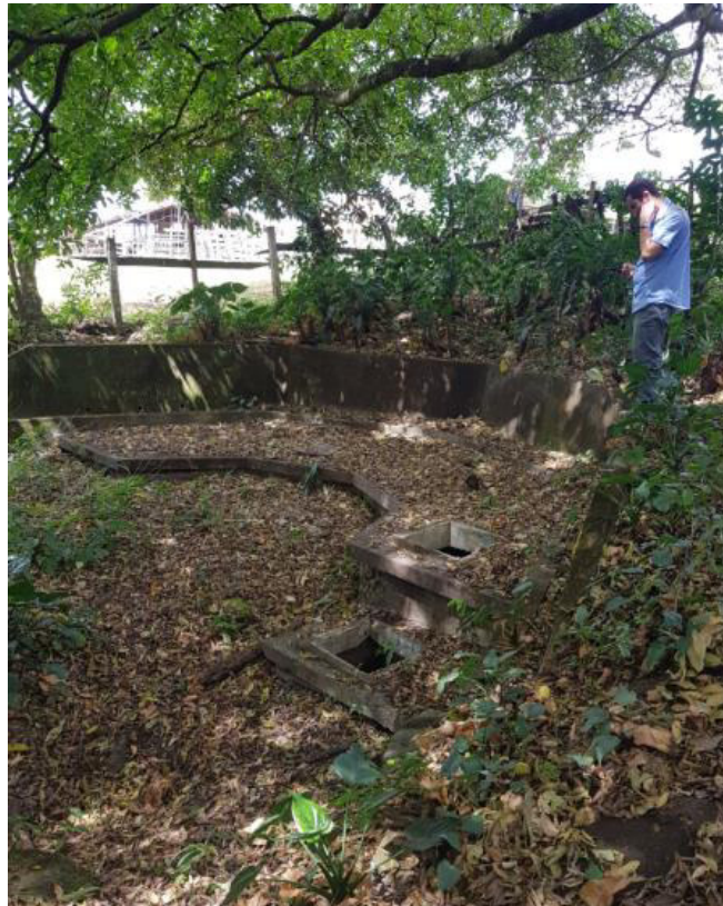
Fotografía N° 14 Captación naciente Katadin 17.
