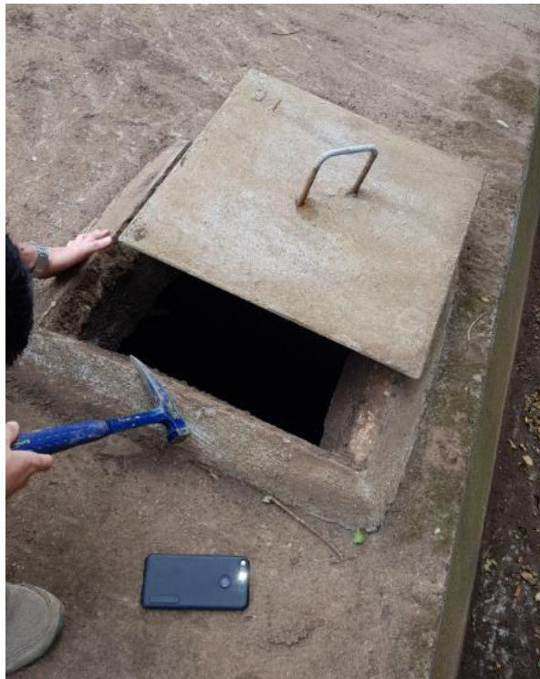
Fotografía N° 5 Captación Naciente Katadin 5.
