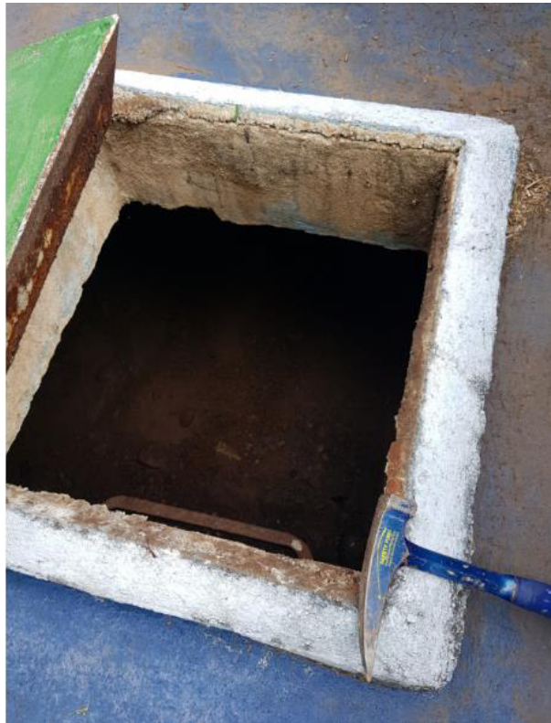
Fotografía N° 4 Captación Naciente Katadin 4.
