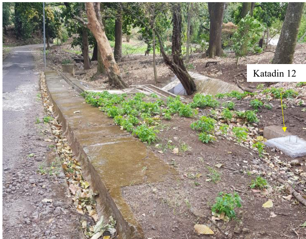
Fotografía N° 11 Captación Naciente Katadin 12.
