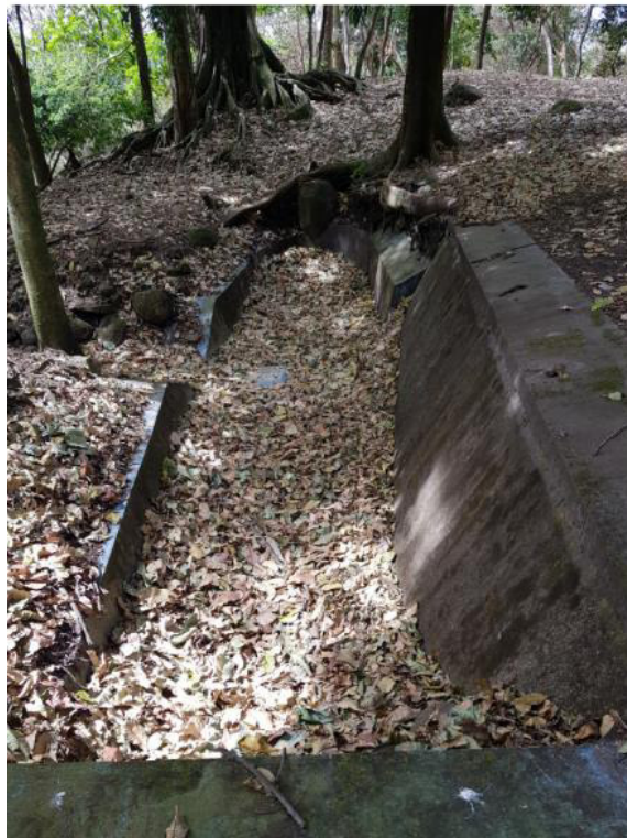
Fotografía N° 9 Captación Naciente Katadin 9.
