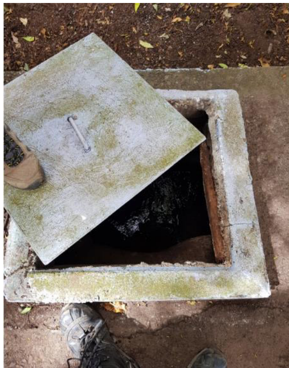
Fotografía N° 6 Captación Naciente Katadin 6.
