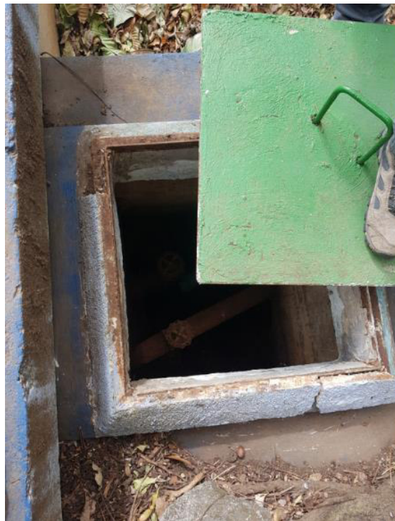
Fotografía N° 3 Captación Naciente Katadin 3.
