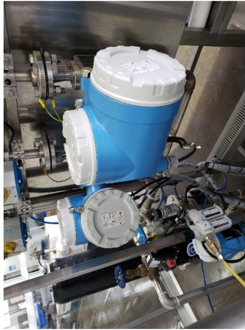
Ilustración 6: Caudalímetros electromagnéticos. Fuente: propia (marzo 2020).
