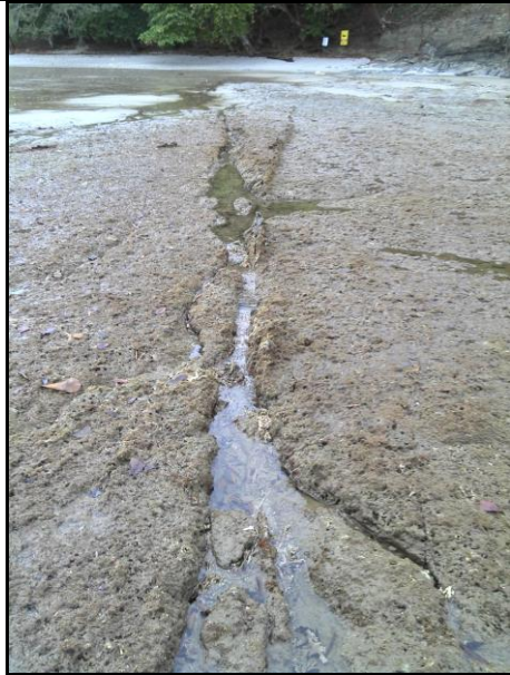
Foto 29 Traza de falla sobre plataforma de abrasión, sector Punta Leona. Coord.: 187815N/463278E.
