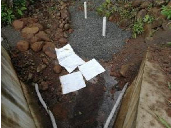
Imagen 1: Fosas en alcantarilla ruta 10.
