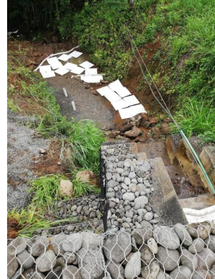
Imagen 2: Fosas en alcantarilla ruta 10.
