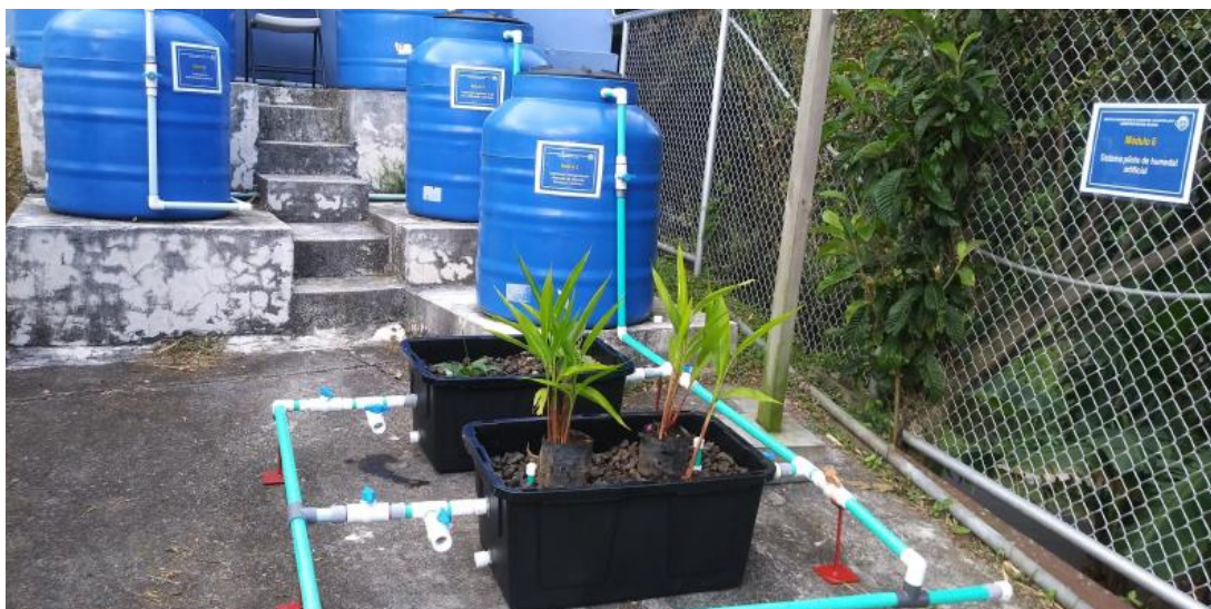
Figura 31. Resultado de la implementación del sistema piloto de humedales artificiales al sistema actual de tratamiento de desechos líquidos (Cordero; Obando, 2020).
