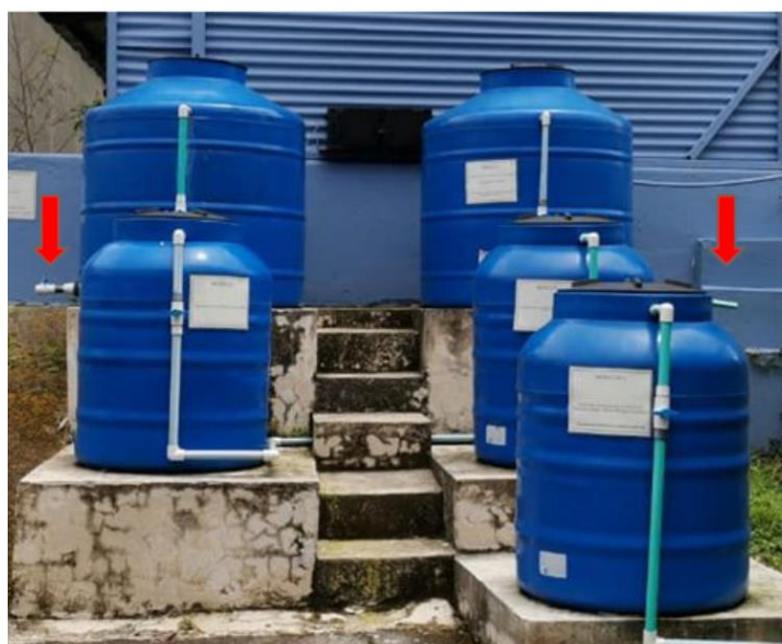
Figura 25. Sistema de Tratamiento de desechos líquidos del Laboratorio Nacional de Aguas
