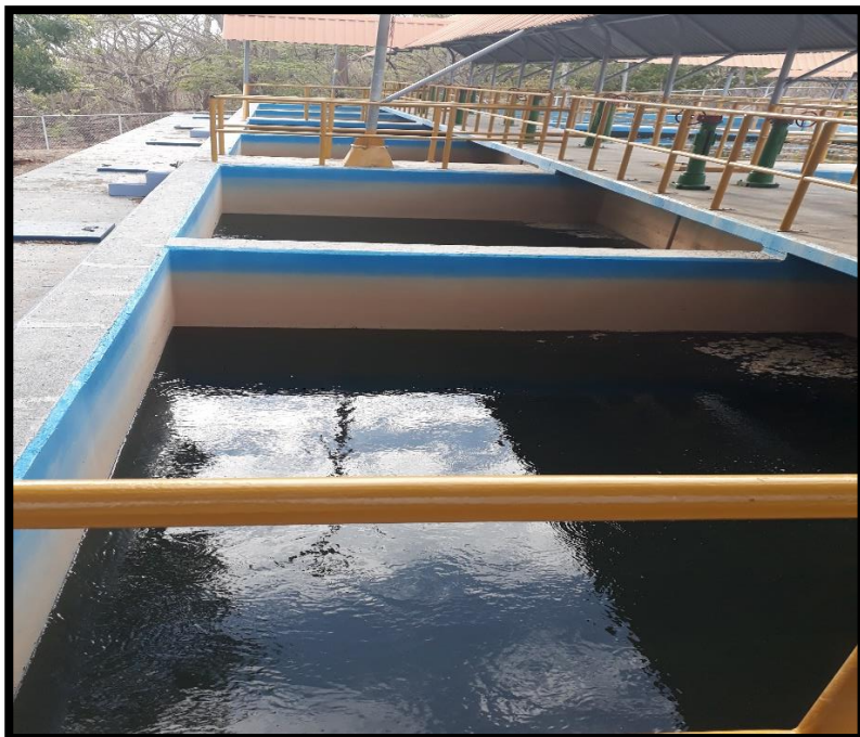
Filtros Fuente: Propia
