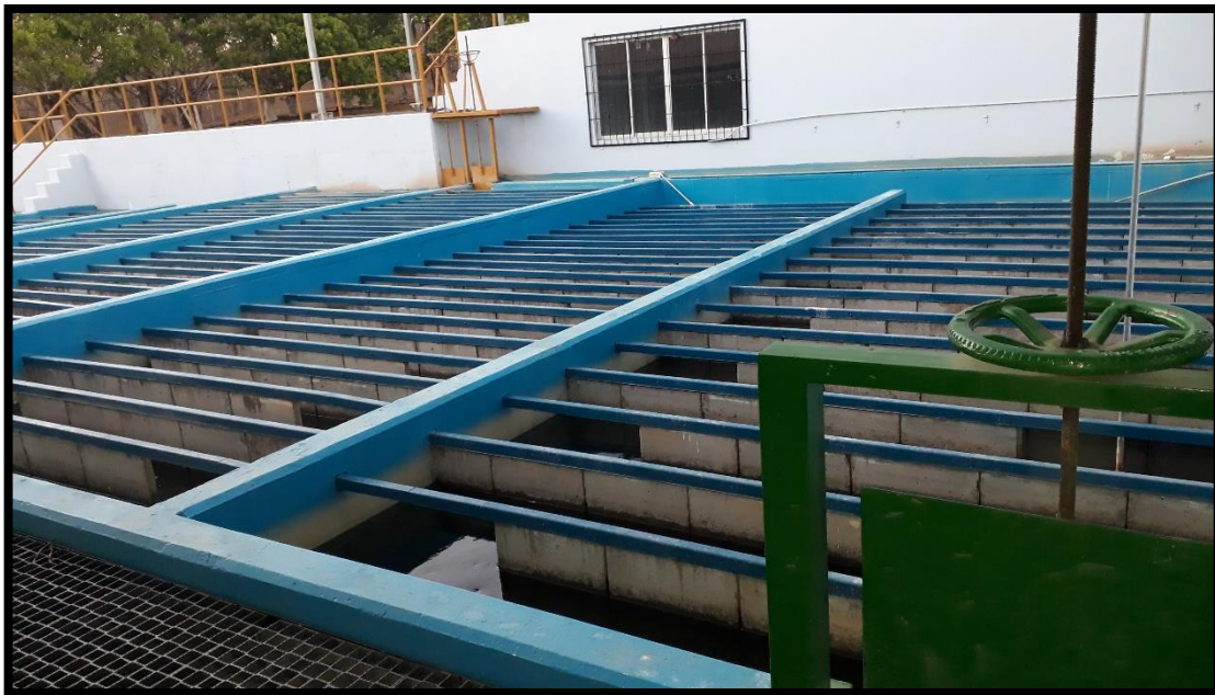
Floculadores Fuente: Propia
