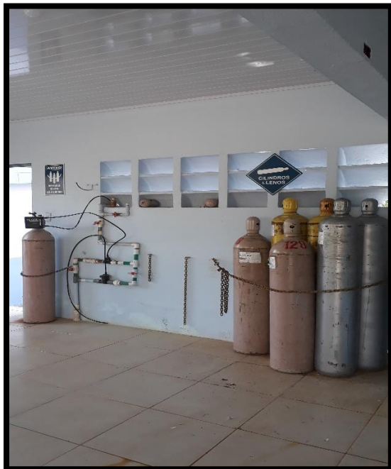
Caseta de cloración Fuente: Propia
