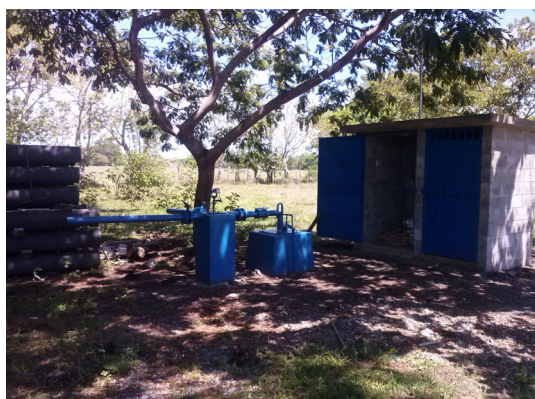
Pozo en operación 04-01, utilizando durante la prueba de bombeo, el equipo previamente instalado.
