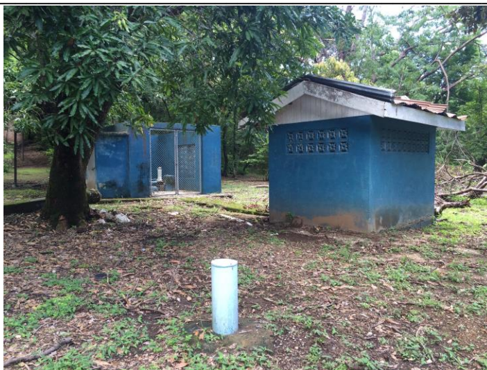
Fotografía 1: Pozo Vigía MT-70 (coordenadas Lambert 232101 – 359011) a la izquierda de la fotografía y tubería expuesta del pozo MT-385 (coordenadas Lambert 232098 – 359010)
