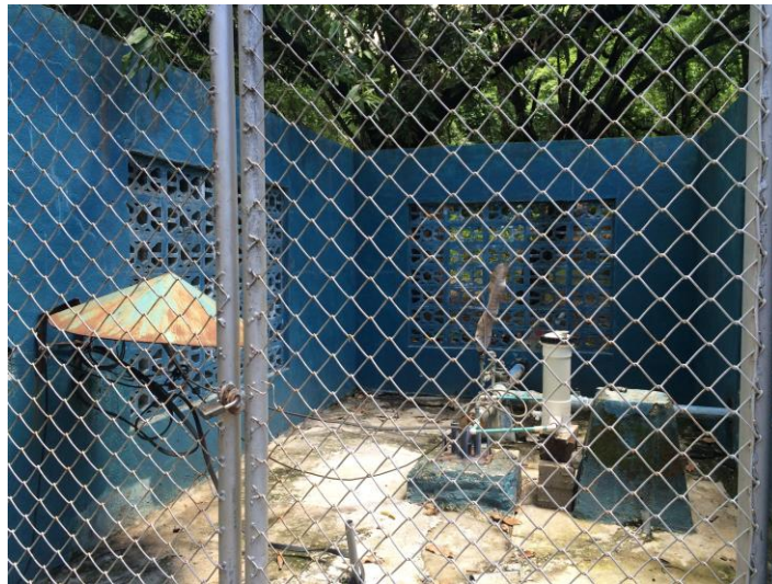
Fotografía 8: Estado actual pozo Vigía (MT-70, coordenadas 395330 – 232101 Lambert Norte)
