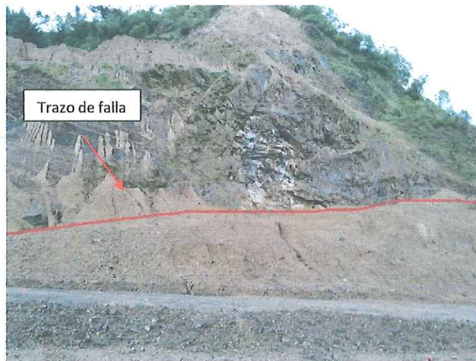
Fotografía 8 Trazo de falla cortando las rocas de la Formación Pacacua (187,456 Norte y 525,096 Este, proyección Lambert Costa Rica Norte).
