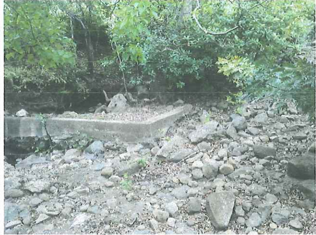
Afloramiento de agua 2. Estructura de concreto alrededor. Coordenadas: 266286/426970
