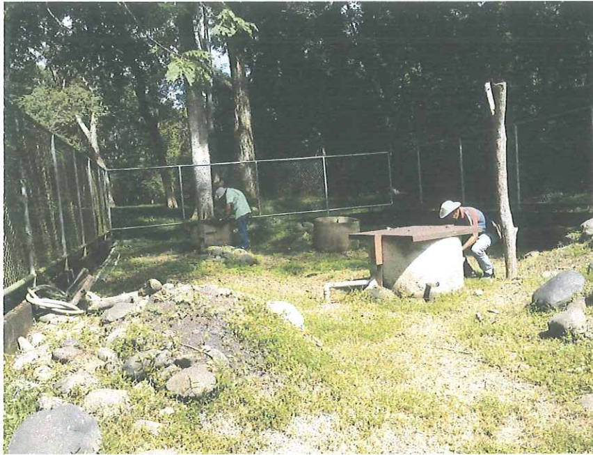
Fotografía 14: Pozos 5 y 6 ASADA de Guaitilar de Abangares, coordenadas 435742 E/ 238392 N (pozo 5) y 435743 E/ 238392 N (pozo 6), nivel estático en 3,92 m.b.n.s (pozo 5) y nivel dinámico en 3,16 m.b.n.s respectivamente.
