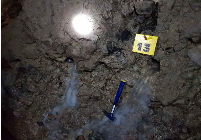
Fotografía N° 8 Sector de afluencia alta de agua en túnel 3 en brecha lávica
