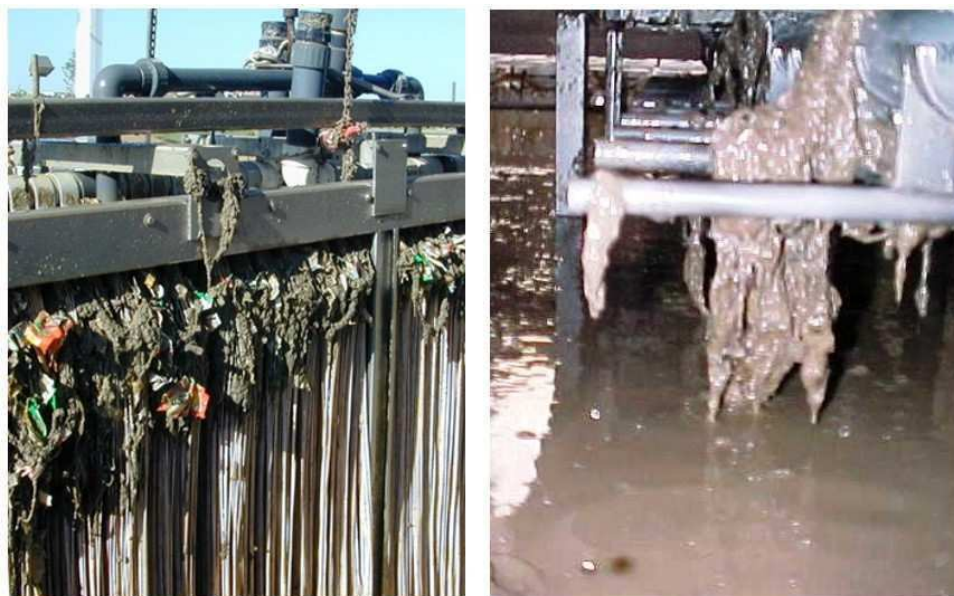
Figura 19. Atascos de materiales fibrosos en sistemas de MBR por insuficiencias en el pretratamiento (falta de rejillas extra finas). (a) Atascos en membranas de fibra hueca. (b) Atascos en tuberías de aireación Fuente: Yoon, 2011.
