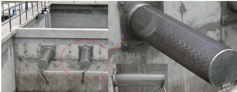
Figura 29. Muro divisorio y cilindros retenedores de biosoportes en el tanque IFAS Fuente: SOLAMSA, 2014b.
