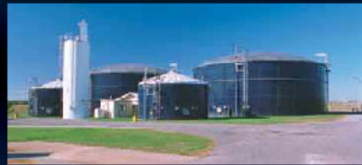
▲ Instalaciones para estabilización y almacenamiento de sedimentos.
