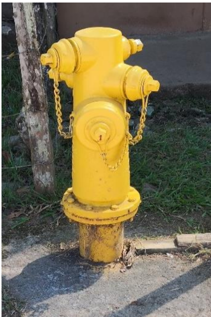
Ilustración 21 Hidrante Multiválvular, comunidad de Pozos.
