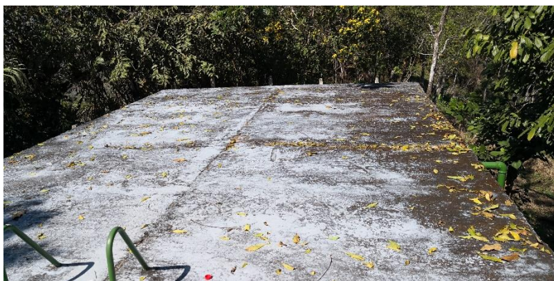
Ilustración 17 Tanque de almacenamiento, comunidad de Pozos.
