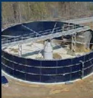
Tratamiento de Aguas Residuales
