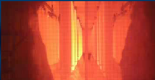
▲ Tecnología de punta en calderas de esmalte de porcelana instalada en 2008.
