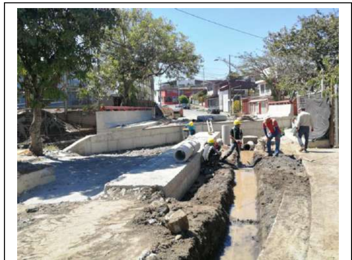
Figura 1. Reconstrucción de puente sobre cauce del río Ocloro, sector El Cerrito, Barrio Luján. 10-02-2020.
