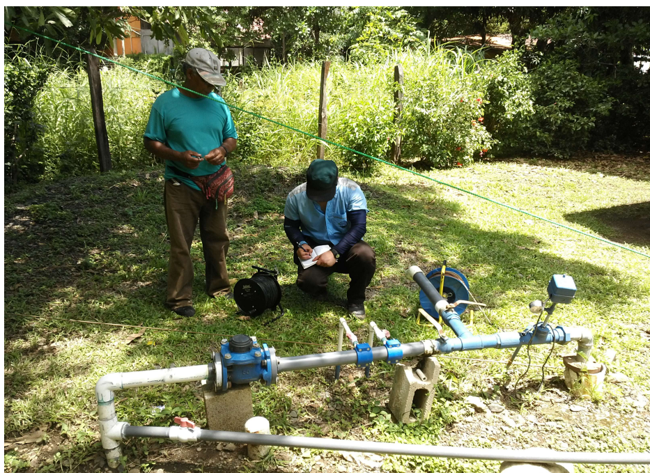
Foto 4. Pozo 4. Coordenadas: 356140 E/217457 N
