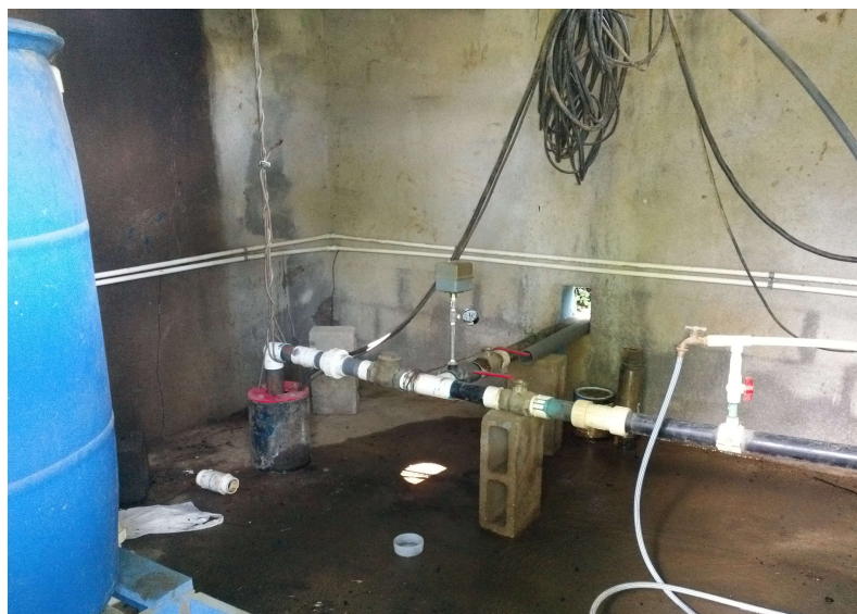
Foto 4. Pozo 3. Coordenadas: 355870 E/217841 N
