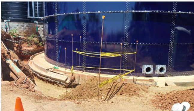
Señalización de excavaciones en la entrada del tanque.
