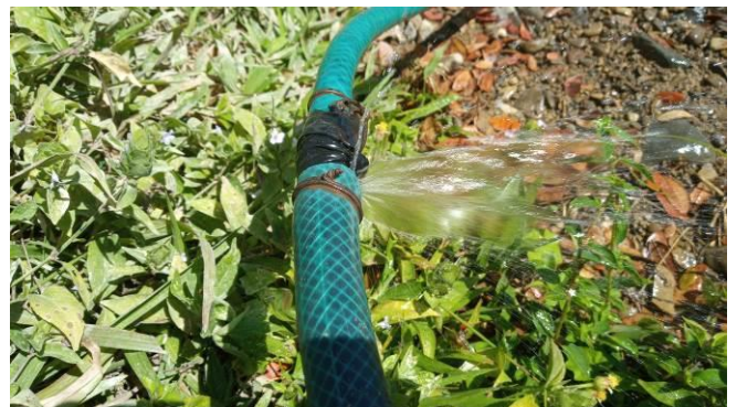
Manguera con fuga de agua produce desperdicio del recurso.
