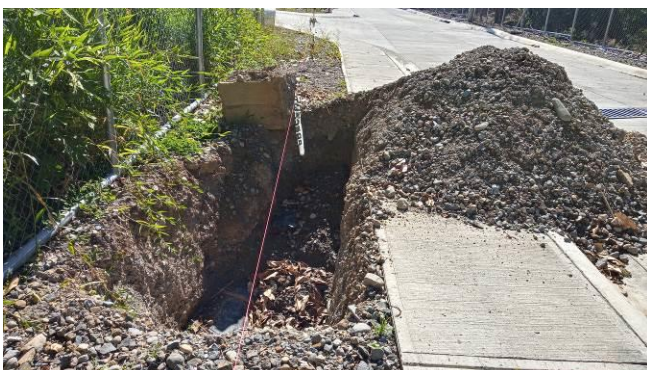
Excavación abierta con señalización deficiente.
