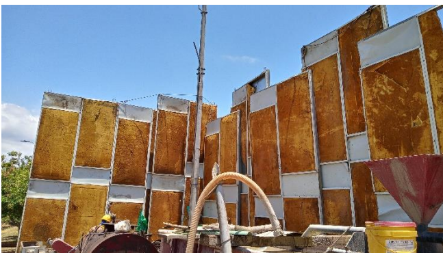
Pantallas de ruido colocadas en el AP.
