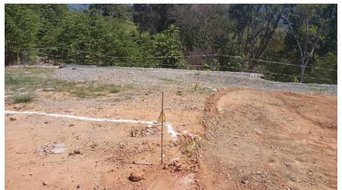
Varillas sin tapones de protección.
