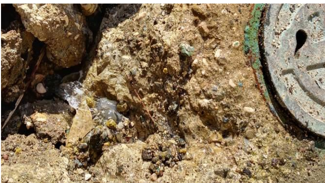
Hidrómetro con fuga de agua.
