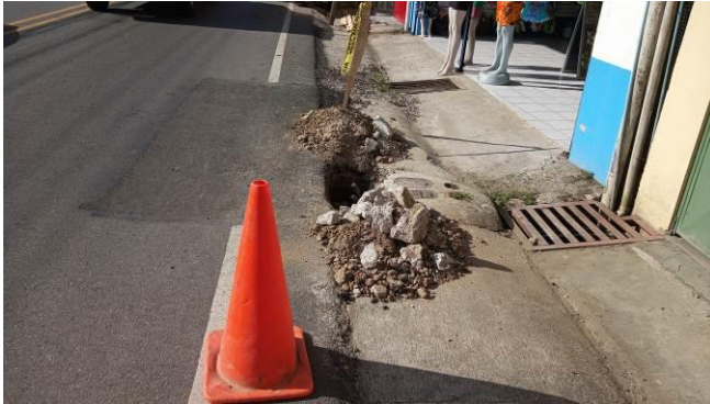
Señalización insuficiente en carretera.
