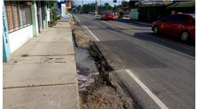
Agua acumulada en el caño debido a falta de reparación en el cordón de caño.
