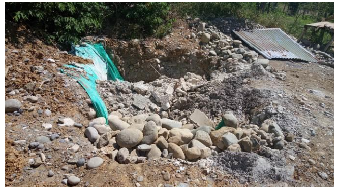
Fosa de concreto a reparar y conformar adecuadamente.
