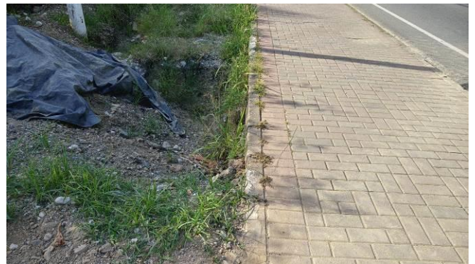
Excavación carente de señalización.
