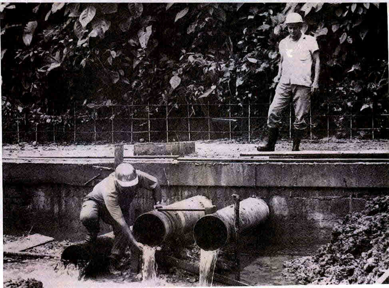
Captación de la fuente N° 2 de Moín, conjunto de 4 manantiales con una producción de 50 litros por segundo.
