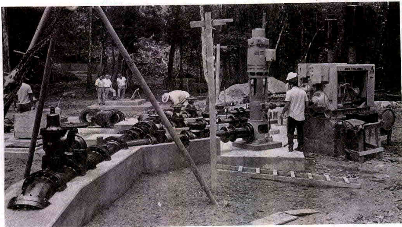
Equipo bombeo Moín, accionado con motores eléctricos y diesel alternos.
