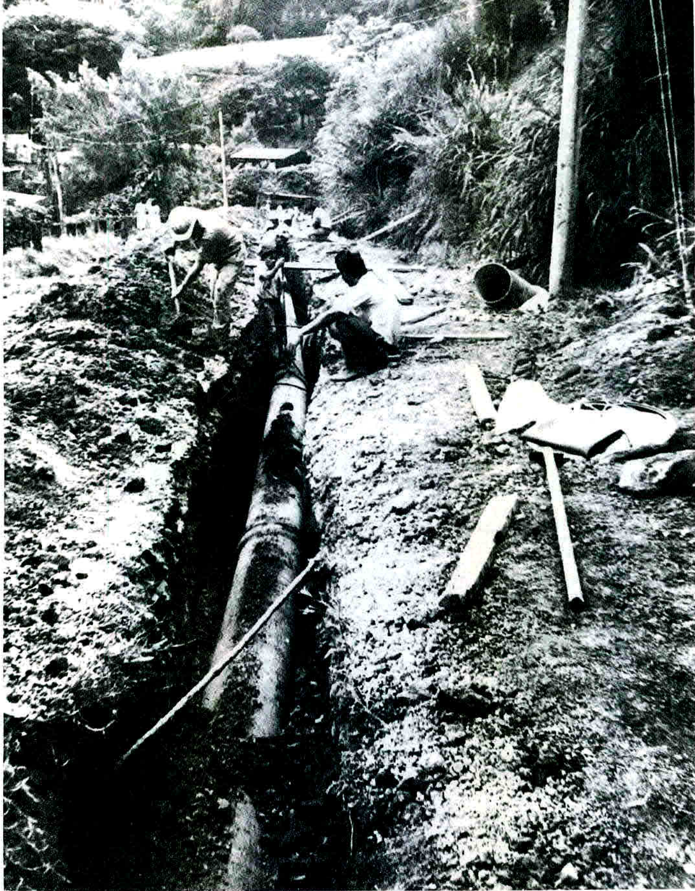
Colocación de tubería en los nuevos trabajos de remodelación de la planta de Los Sitios.
