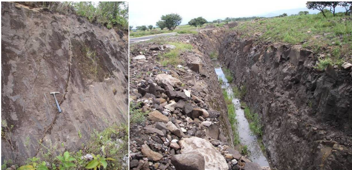
Fotografía 2. Afloramientos de la Formación Bagaces en los alrededores del Aeropuerto de Liberia (izq.: 371200E-287600N; der.: 368500E-2863000N). Son ignimbritas soldadas gris oscuro con fracturas múltiples, la mayoría por enfriamiento.
