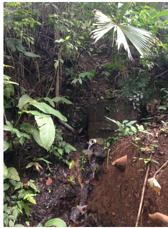
Fotografía 3. Captación IDA n°1. Coordenada N 481756 m y E 184780 m, Costa Rica Lambert Norte.
