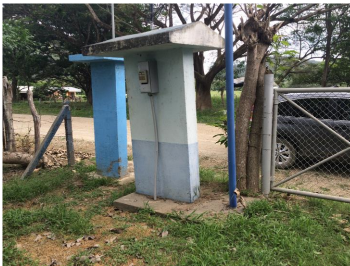
Fotografía 4: Entrada de acceso a pozo Portegolpe, (coordenadas 258,485 latitud – 346617 longitud, Lambert Norte)
