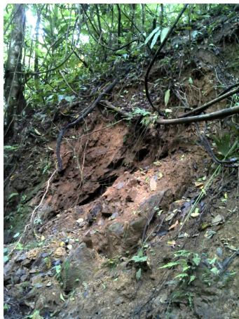
Fotografía 7. Sitio de Toma, donde se puede observar la corona de deslizamiento. Coordenadas E 567892 m y N 138942 m, Costa Rica Lambert Norte.
