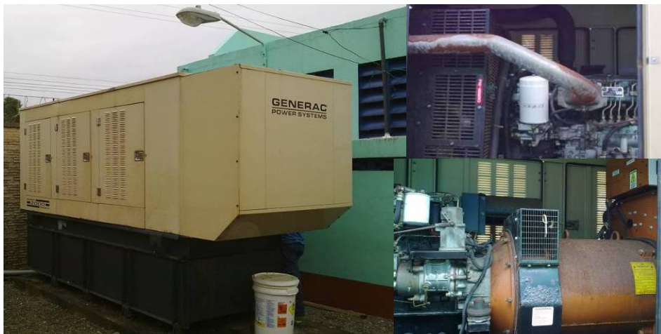
Fotografía 4.13 Planta Generadora EPA
