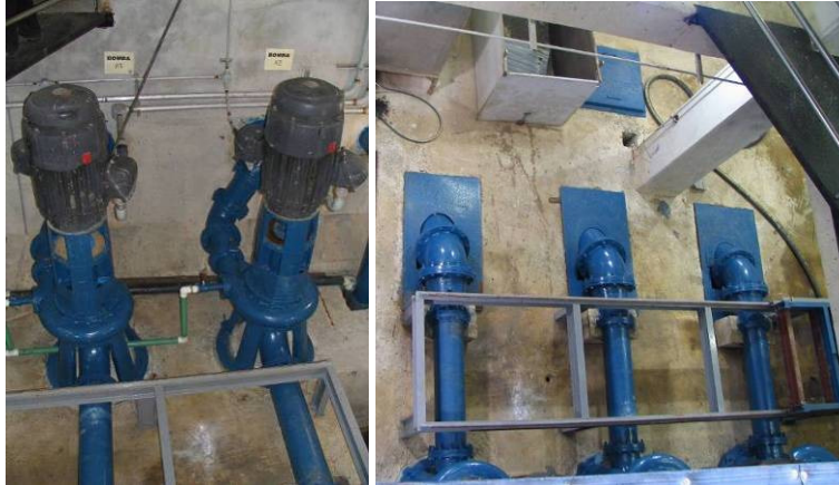
Fotografía 4.10 Antiguas bombas centrífugas
