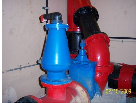
Fotografía 4.11 Accesorios de la línea de bombeo
