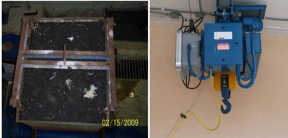
Fotografía 4.10 Canastas de sólidos y sistema de izaje
