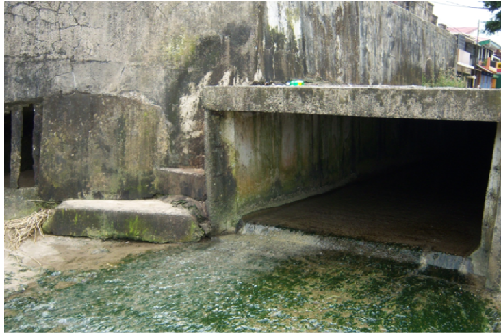
Fotografía 5.3 Canaleta de salida al mar del alcantarillado pluvial
