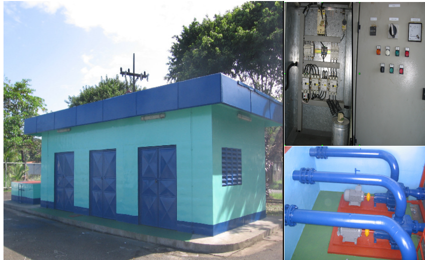
Fotografía 4.2. Edificación, los paneles de control, las Bombas y la tubería de impulsión de la Estación de Aguas Residuales Asis Esna.
