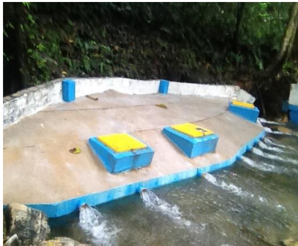
Fotografía 7: Captación naciente San Antonio 1, (coordenadas 589366 – 284489 Lambert Norte), margen izquierda quebrada Sin Nombre
