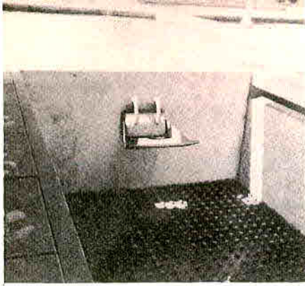
Planta de Guadalupe - Una de las nuevas unidades filtrantes completamente terminada. En el fondo falso se ven las boquillas de admisión ya instaladas.
