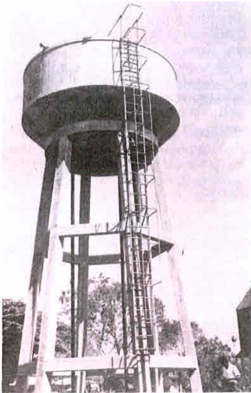
Tanque de Almacenamiento en Palmira de Carrillo
