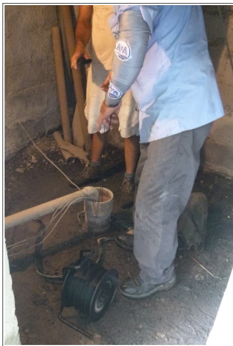
Fotografía 10. Pozo P-9, Hotel Oasis (Coordenadas: 213 232 N y 430 505 E)
